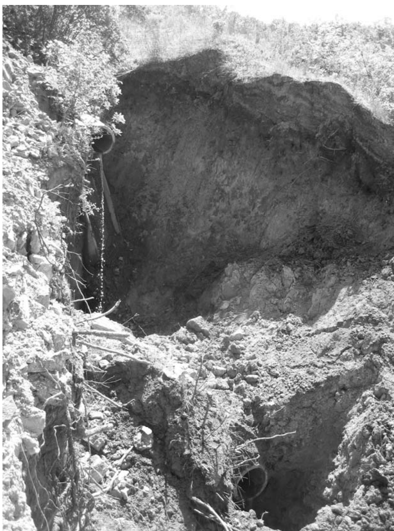
Рис. 3. Зруйнований колектор на просадкових ґрунтах в Тунельній балці
