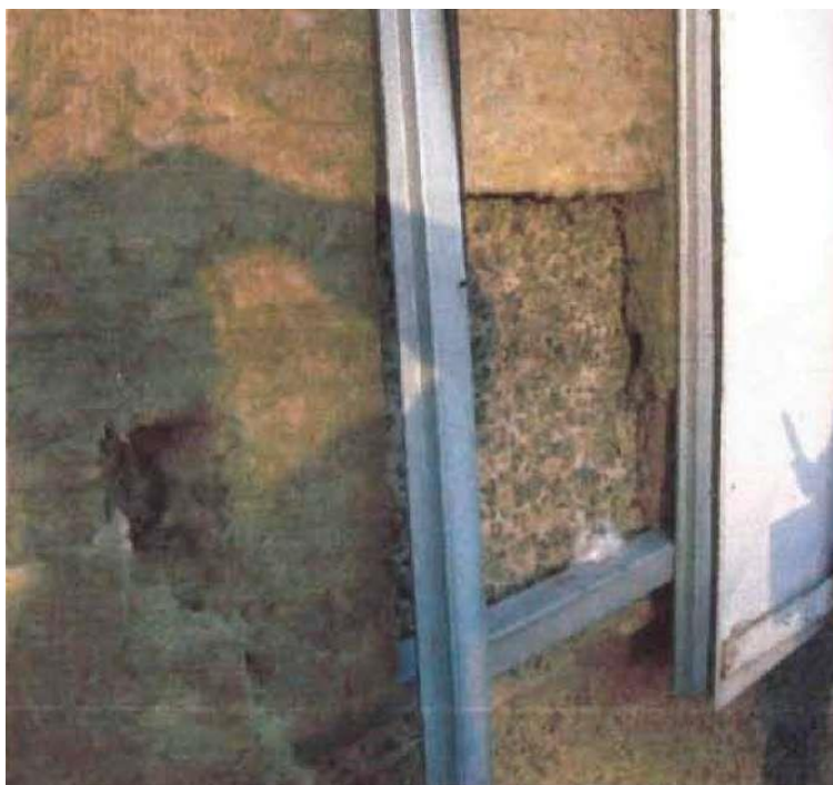
Рис. 6. Розкритий ділянку навісного вентиляваного фасаду. Деформації несучих конструкцій (вертикального профілю)
