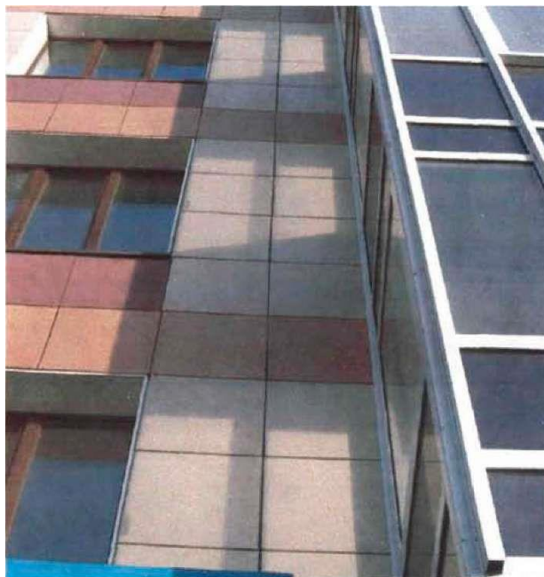
Рис. 1. Нерівний вертикальний шов (Фасадна система з облицюванням керамогранітними плитами)
