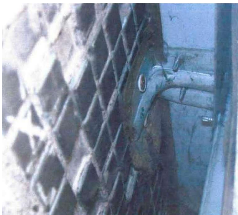
Рис. 7. Вид зсередини розкритого ділянки. Деформації несучих конструкцій (кронштейна)
