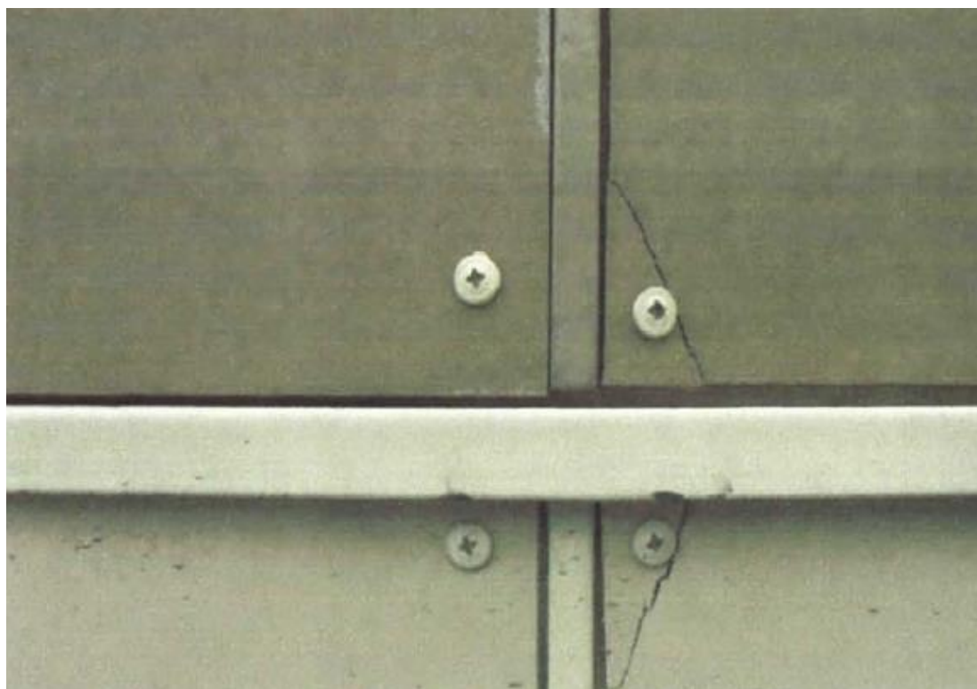
Рис. 11. Скол облицювальної плити в місці кріплення її самонарізними гвинтами до несучого каркасу
