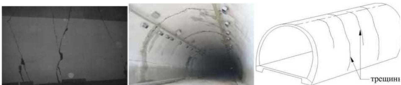
Рис.3. Форма повреждений - поперечные трещины
