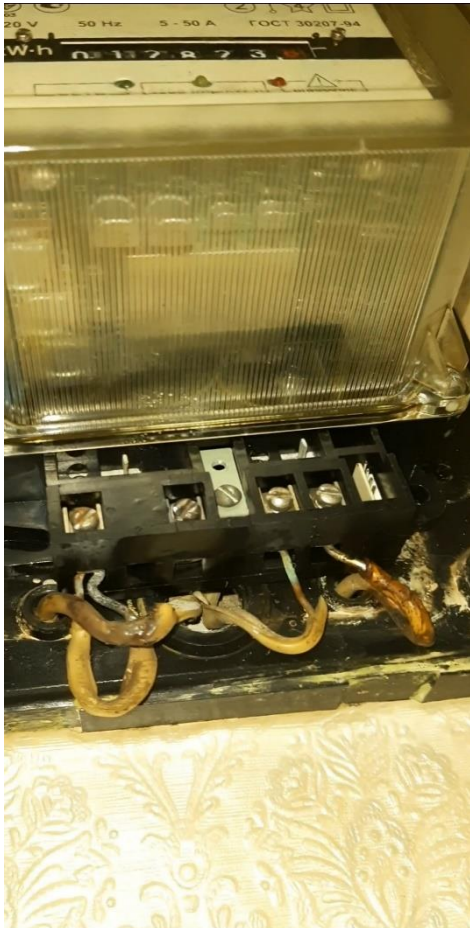
Рисунок 1.5 Неправильне підключення приладу обліку
