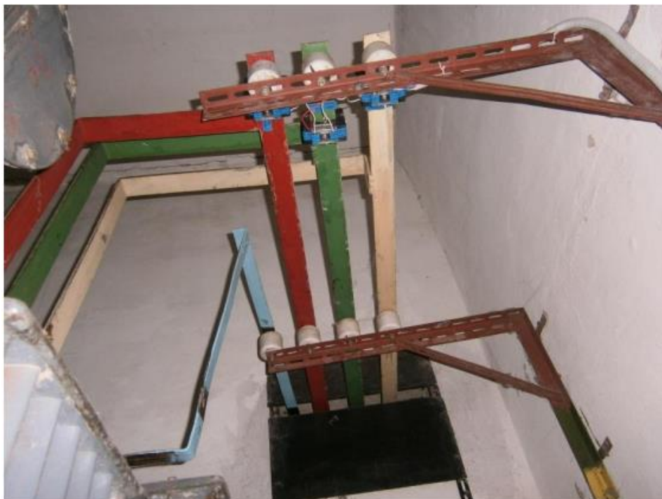
Рисунок 1.3 Неправильна установка трансформаторів струму
