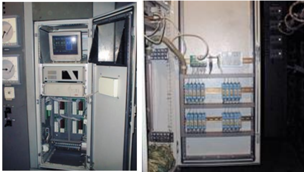
Рисунок 1.4 – Вид шафи, де розміщені контролери нижнього рівня системи (зліва – фронтальний вид, справа – вид зі зворотної сторони)
