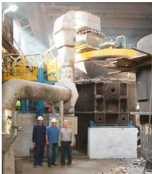
Рисунок 1.2 – Загальний вигляд установки сушки ковшів
