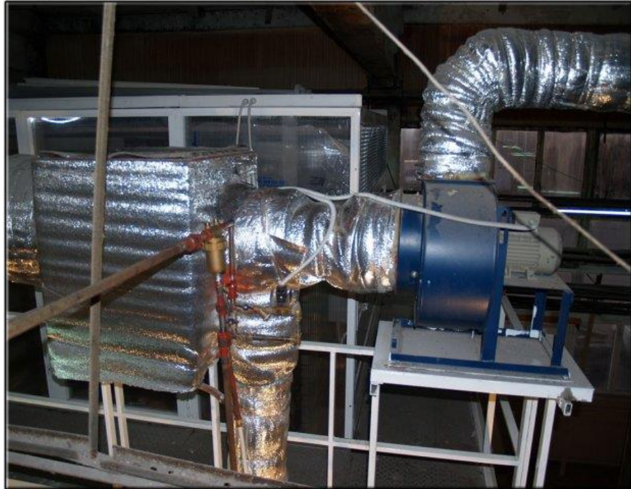
Рисунок 1.3 – теплообмінний короб (куб) призначений для утворення насиченої суміші, а також під'єднаний до нього вентилятор рециркуляції (мікроклімату)
