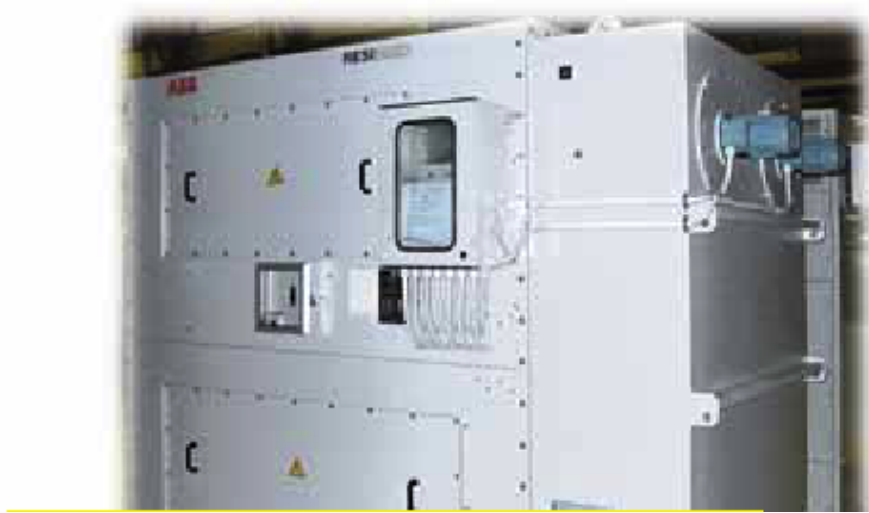
Рисунок 3.10 – Трансформатор з повітряно-водним охолодженням IP 54 виконаний для потреб гірничої промисловості
