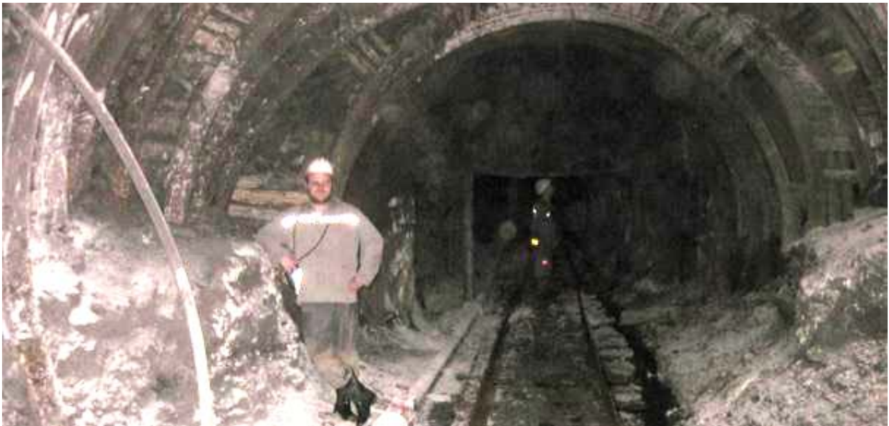
Рис. 2. Стан конвеєрного ходка після підривання порід підшоши до підходу лави
