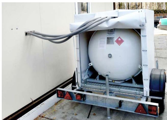
Рис. 4.69. Пересувний спеціалізований причіп-газгольдер до легкового автомобіля, підключений до системи опалення котеджу
