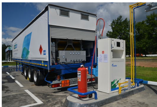
Рис. 4.43. Колонка дочірньої АГНКС с газовозом-напівпричепом
