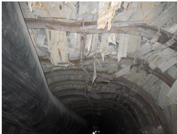
Рис. 3. Деформирование крепи вентиляционного штрека № 3 за пределами расчетной зоны повышенного горного давления
