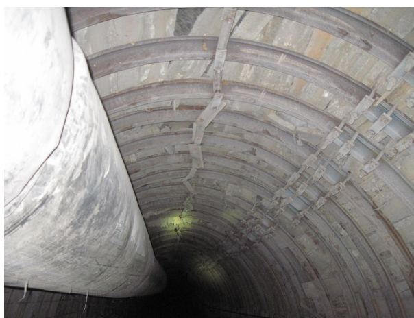
Рис. 2. Состояние вентиляционного штрека № 3 в начале расчетной зоны повышенного горного давления
