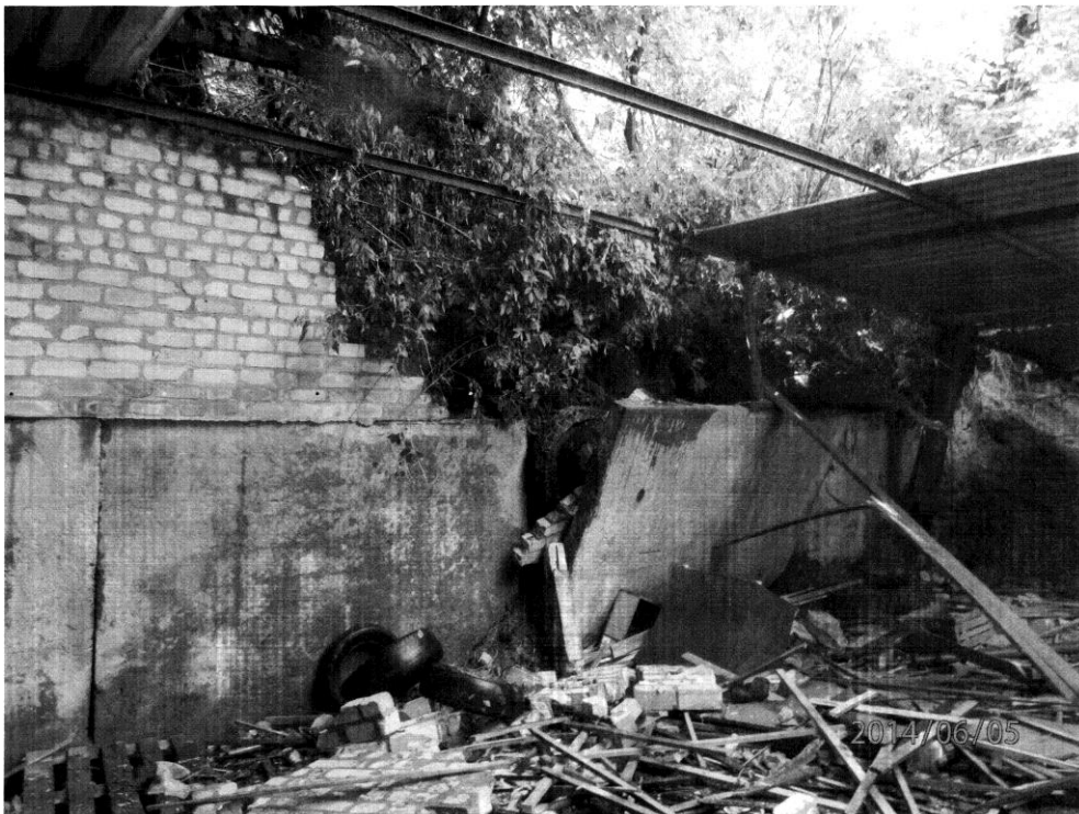
Рис. 3. Руйнування підпірної стінки (Батієва гора, травень – червень 2014 р.)
