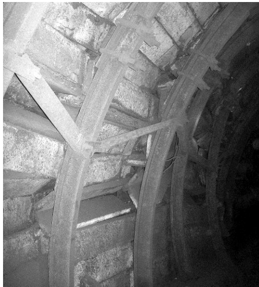
Рис. 6. Явление складывания затяжки «в гармошку». Шахта «Комсомолец Донбасса»
