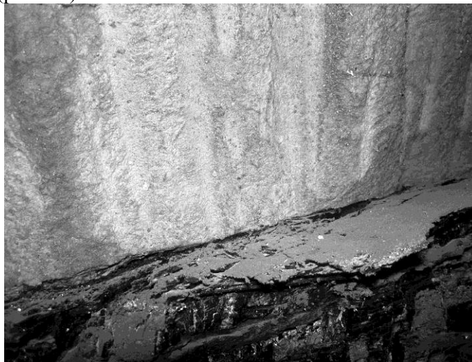
Рис. 12. «Псевдопучение» угля из-под песчаника, пласт l_2' , 2-й южный конвейерный штрек шахты «Алмазная»
