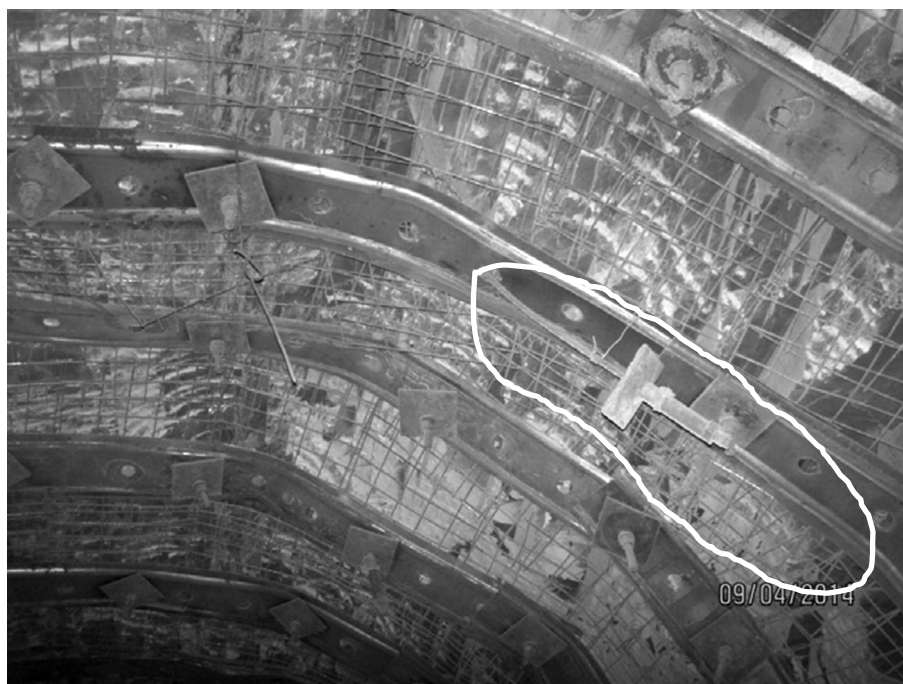
Рис. 2. Деформации массива и элементов крепи при подходе лавы на расстояние 90 м. Виден провисающий канатный анкер
