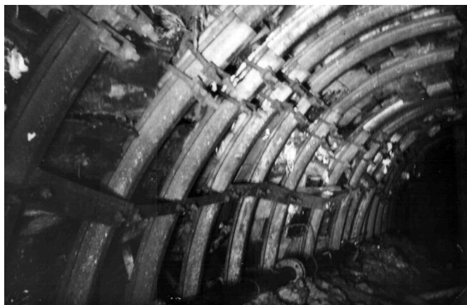
Рис. 9.8. Общий вид 553 бортового штрека вблизи сопряжения с 551 лавой, закреплен рамно-анкерной крепью, анкера с гибкими стяжками перекрыты породами почвы
