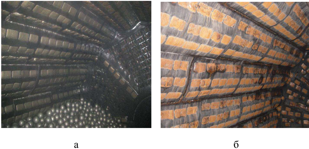
Рис. 5. Резиново-металлическая футеровка производства "Валса ГТВ" в мельнице первой стадии: а – 870 часов; б – 3300 часов
