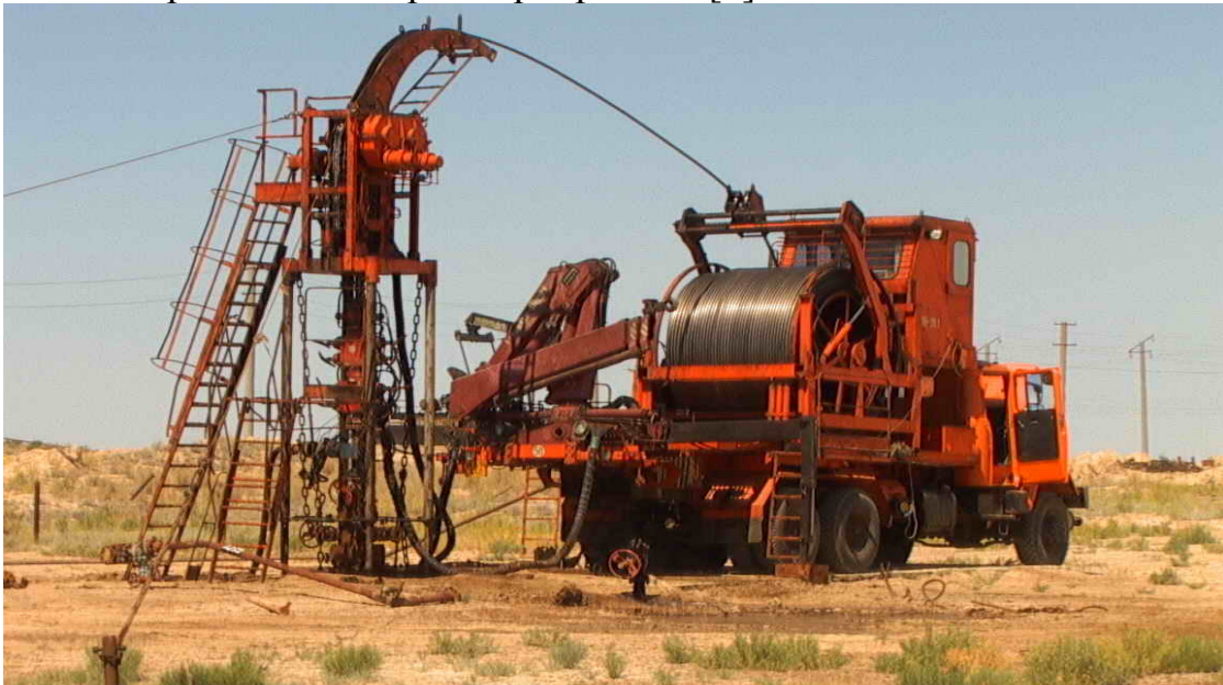
Рис. 1.1. Загальний вигляд установки що використовує колону гнучких труб
