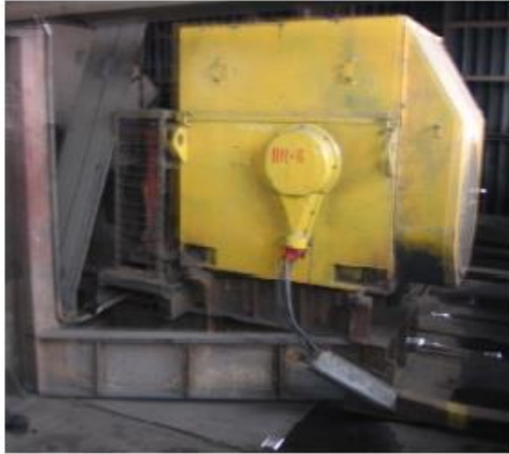
Рис. 1.7 Электродвигатель приводной станции конвейера.
