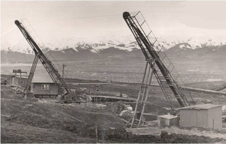
Бурові установки для буріння похилих свердловин на Ангренській і Південно Абинській станціях «Підземгаз» (1985 р.)
