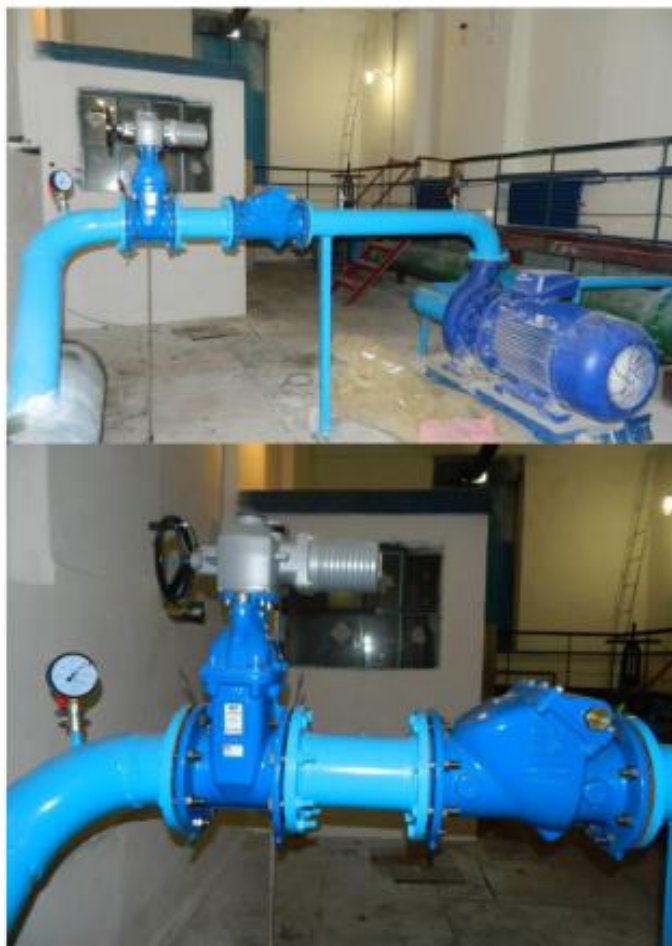
Рисунок 1.3 – Насосна станція 3-го підйому
