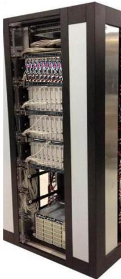
Рис. 2.14. Монтажна стійка багатопроцесорного комплексу з вмонтованим в нею обладнанням. Загальний вигляд
