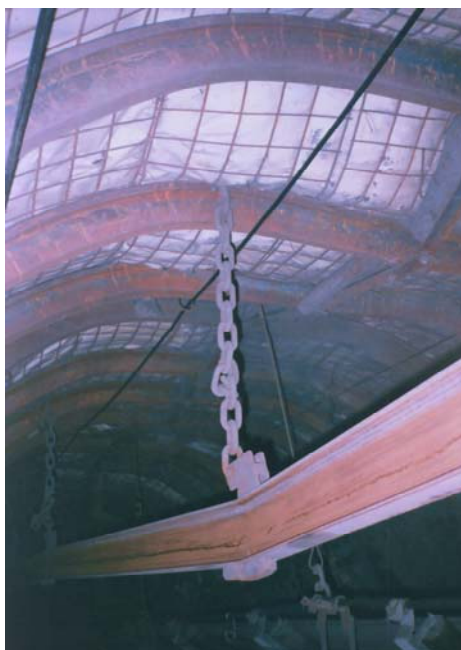
Рис. 1.7. Состояние трассы монорельса и крепи подготовительной выработки в зонах активного смещения пород кровли
