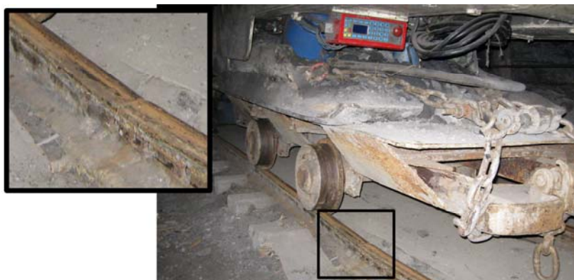
Рис. 2.12. Состояние стыковых соединений рельс при транспортировании крупнотоннажных грузов
