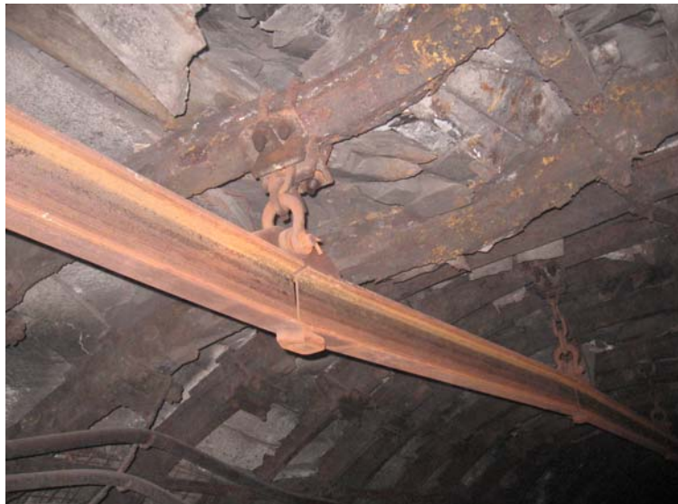
Рис. 2.8. Состояние крепи подготовительной выработки в зонах активного смещения пород кровли
