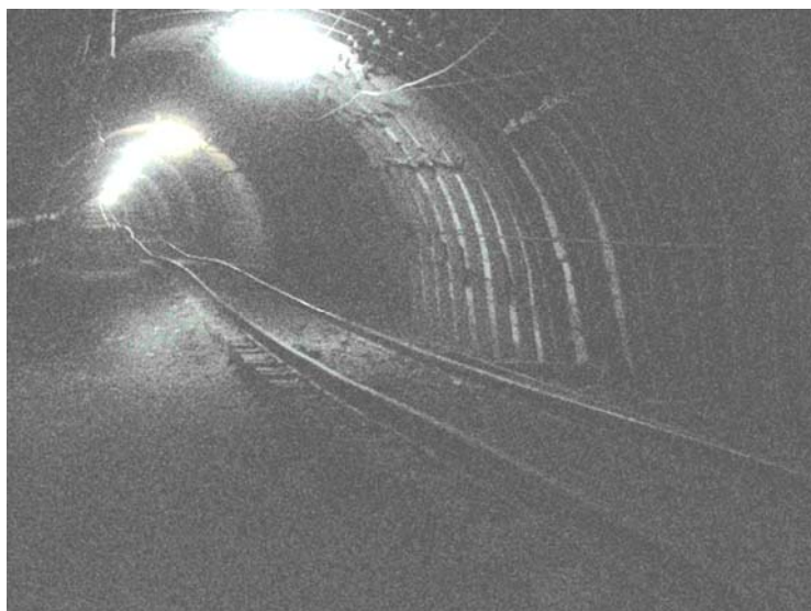
Рис. 1.3. Знакопеременный профиль пути – вентиляционный наклонный квершлаг на пл. С 4 , шахта «Павлоградская» ПАО «ДТЕК Павлоградуголь»
