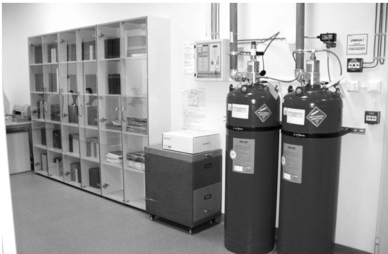
Fot. 17. Specjalistyczny sprzęt przeciwpożarowy.
