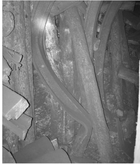
Рис. 4. Стан ділянки підготовчої гірничої виробки на ш. Терновська, Західний Донбас
