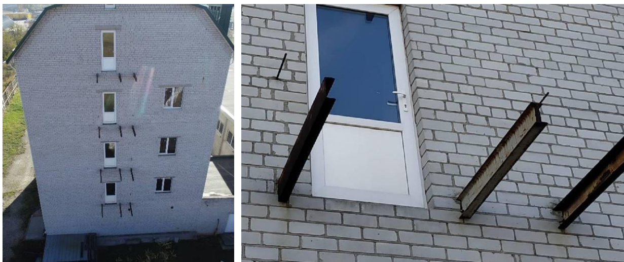
Рисунок 3.3 – Відсутність аварійних пожежних сходів по ряду В, корозію елементів консольних балок
