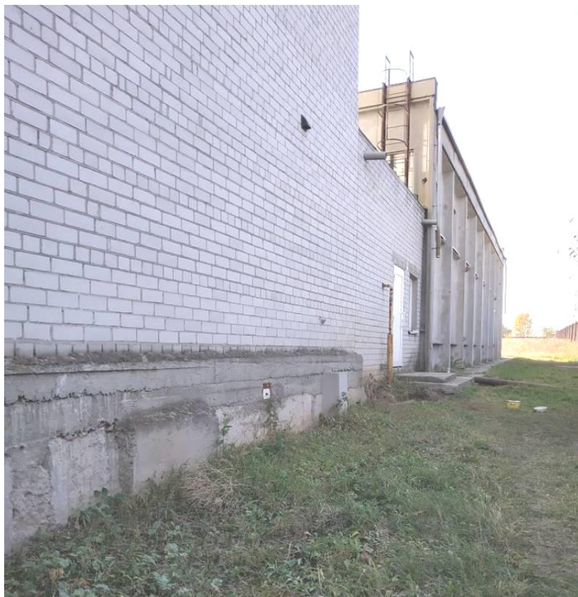
Рисунок 3.1 – Відсутність отмостки будівлі АБК по ряду Б
