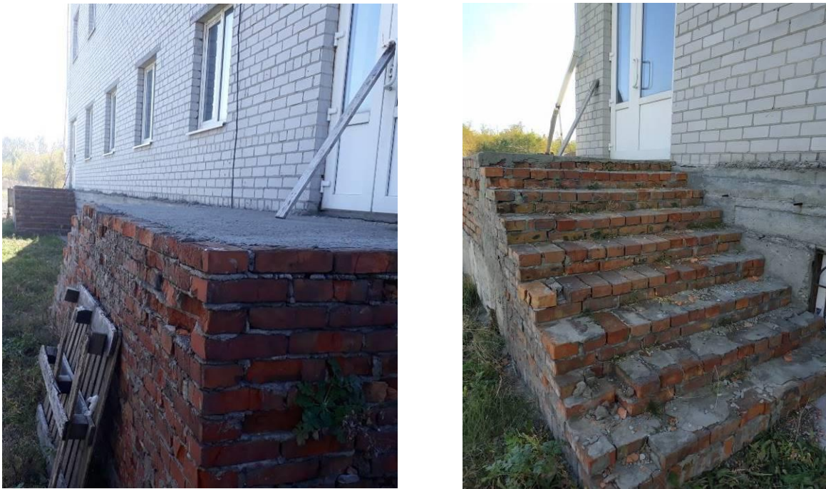
Рисунок 3.2 – Відступ від проекту вхідних груп будівлі, руйнування цегляної кладки
