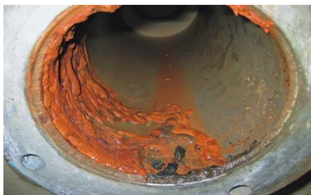
Рис. 1. Корозія внутрішньої стінки шахтного газопроводу
