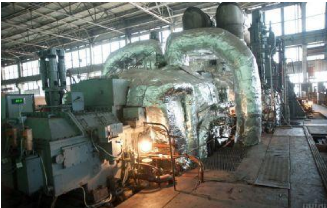
Рис. 1. Аварія в робочому приміщенні
