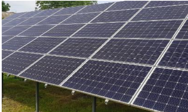
Рис 2.1 - Фотовольтаїчні сонячні панелі (PV)
