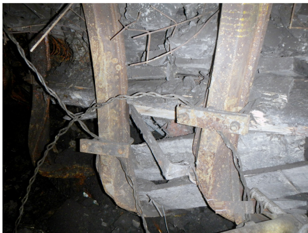
Рисунок 1.7 – Фрагменти стану кріплення виїмкових виробок шахт Західного Донбасу в зоні впливу очисних робіт: a – фрагмент №1; б – фрагмент №2; в – фрагмент №3
