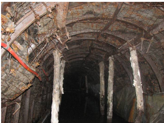
Рисунок 1.11 – Фрагменти стану кріплення виїмкових виробок шахт Західного Донбасу в зоні впливу очисних робіт: a – фрагмент №13; б – фрагмент №14; в – фрагмент №15
