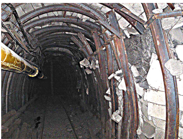
Рисунок 1.8 – Фрагменти стану кріплення виїмкових виробок шахт Західного Донбасу в зоні впливу очисних робіт: a – фрагмент №4; б – фрагмент №5; в – фрагмент №6
