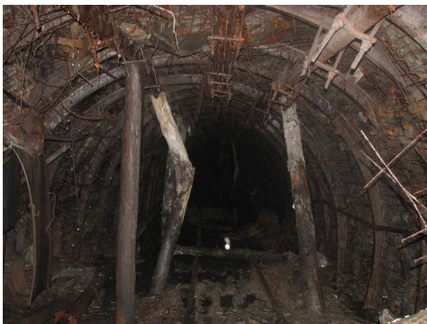
Рисунок 1.10 – Фрагменти стану кріплення виїмкових виробок шахт Західного Донбасу в зоні впливу очисних робіт: a – фрагмент №10; б – фрагмент №11; в – фрагмент №12
