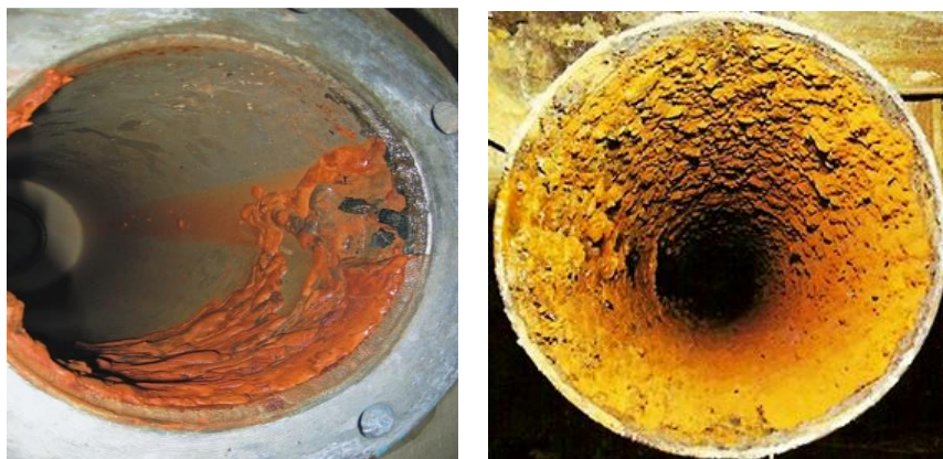
Рисунок 2.9 – Корозія внутрішньої стінки труби
