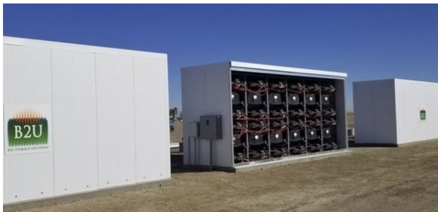
Рисунок 2.10 – сховища електроенергії B2U
