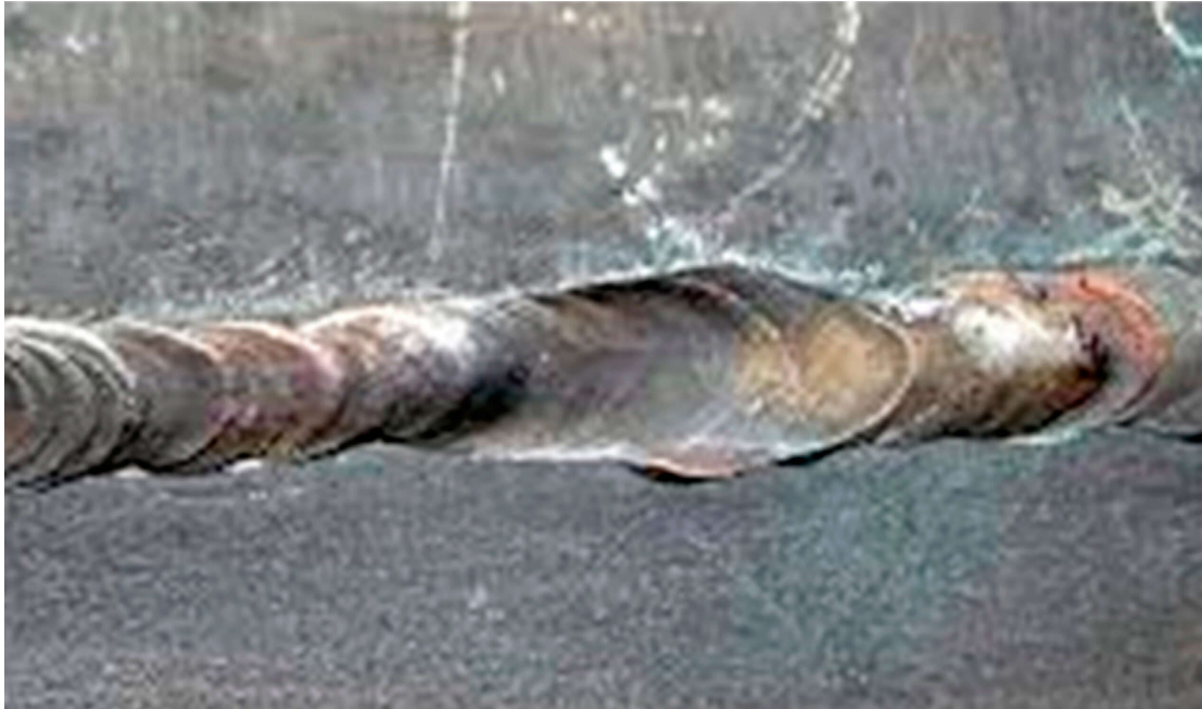
Рисунок 4.2 – Видимий дефект зварювального шва
