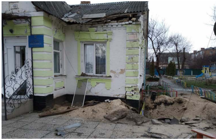
Рис.3.7 Зруйнований дошкільний навчальний заклад №2 «Веснянка» [69]
