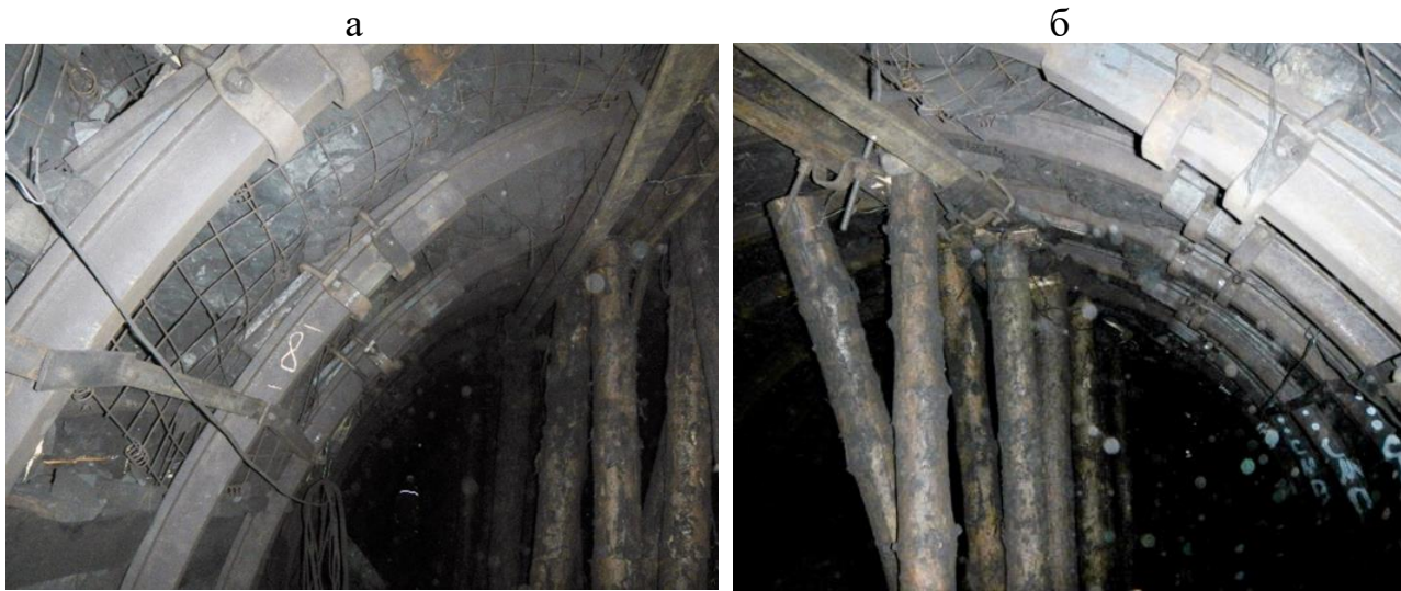
Рис. 8. Стан 148 збірного штреку при його повторному використанні після раннього виявлення зон підвищених деформацій та встановлення дерев'яних стояків кріплення посилення: неробочого (а) та робочого (б) бортів виробки
