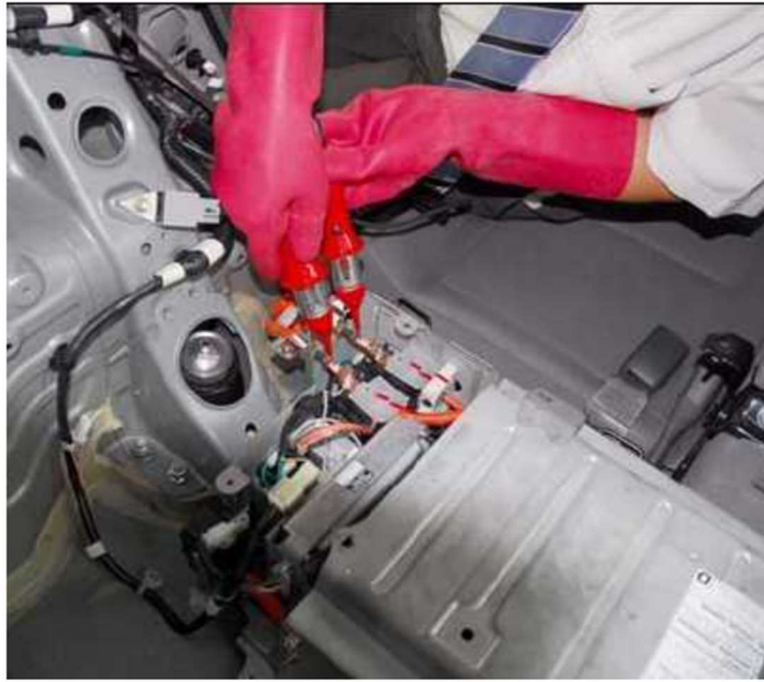
Рис. 5.14. Перевірка напруги у високовольтній системі на Prius 2-го покоління
