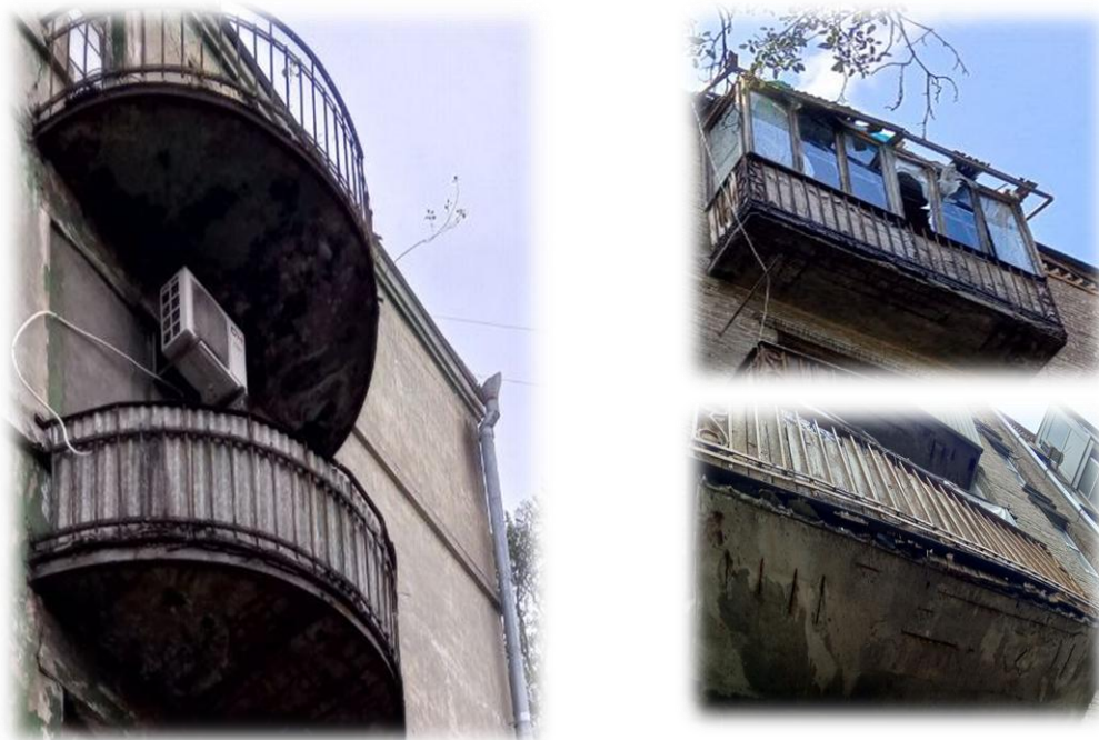
Рис. 1. Дефекти плит балконів житлових будинків (сколи, тріщини, оголення та корозія арматури)
