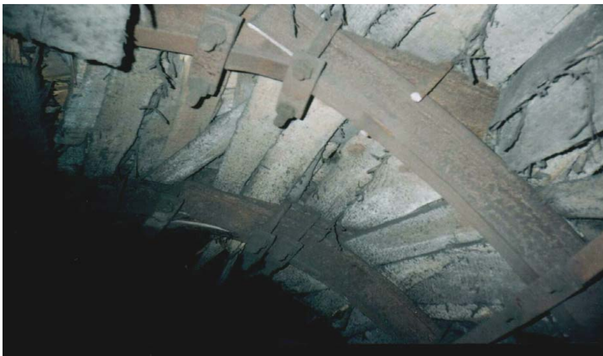
Рис. 4.19. Характерные разрушения элементов арочной крепи а) со стороны массива, б) и в) со стороны выработанного пространства
