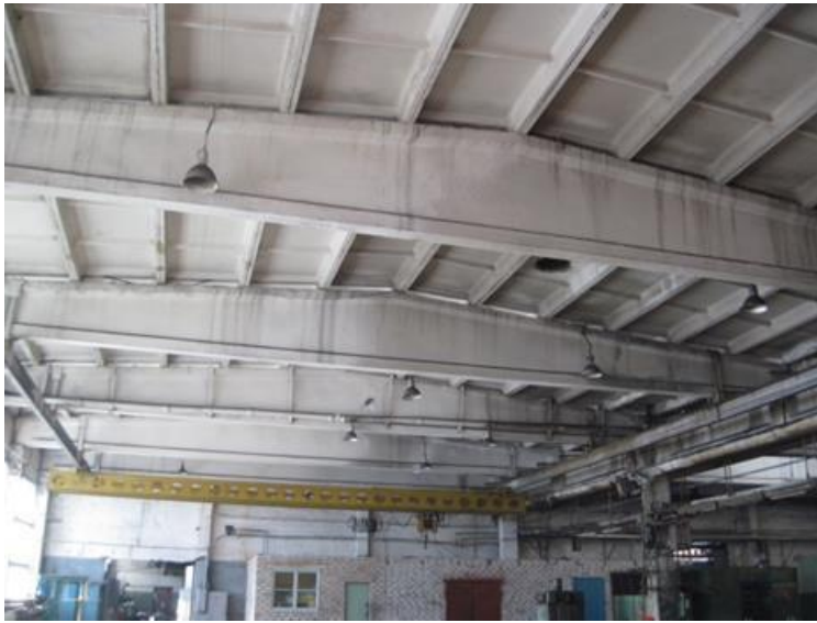
Рисунок 2.15. Характерні пошкодження збірної велико пролітної балки
