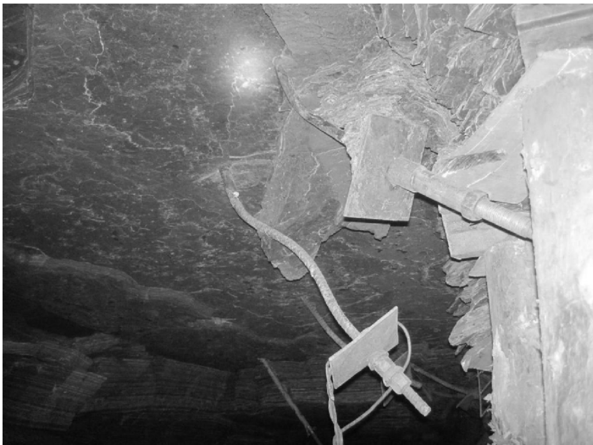
Рис. 3.16. Деформации анкерного крепления в демонтажной камере
