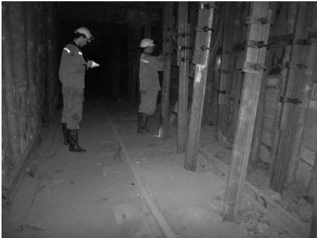
Рис. 3.4. Оценка состояния выработки в ходе визуального обследования
