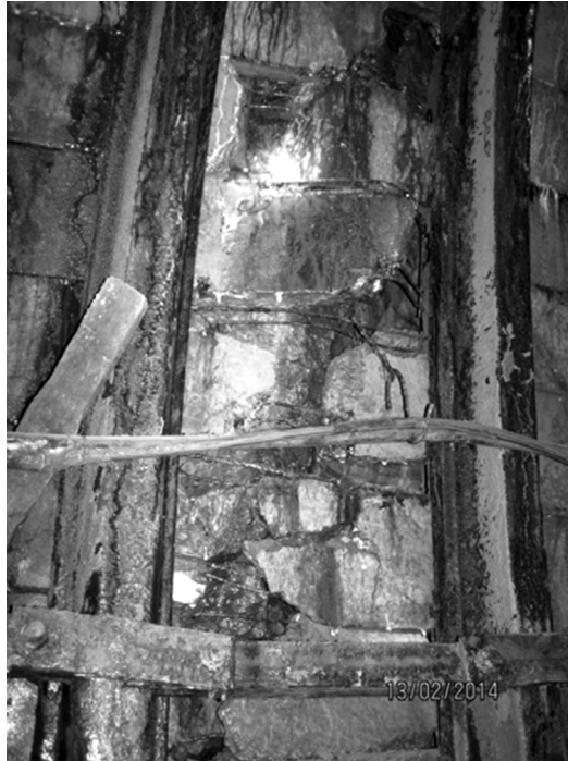
Рис 5. Деформация межрамных затяжек
