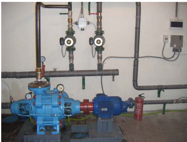
Рис. Рис. 1 Агрегат термодинамический на одной из тепловых станций Украины. Вид сбоку на установку и частотный преобразователь ATV-21.
