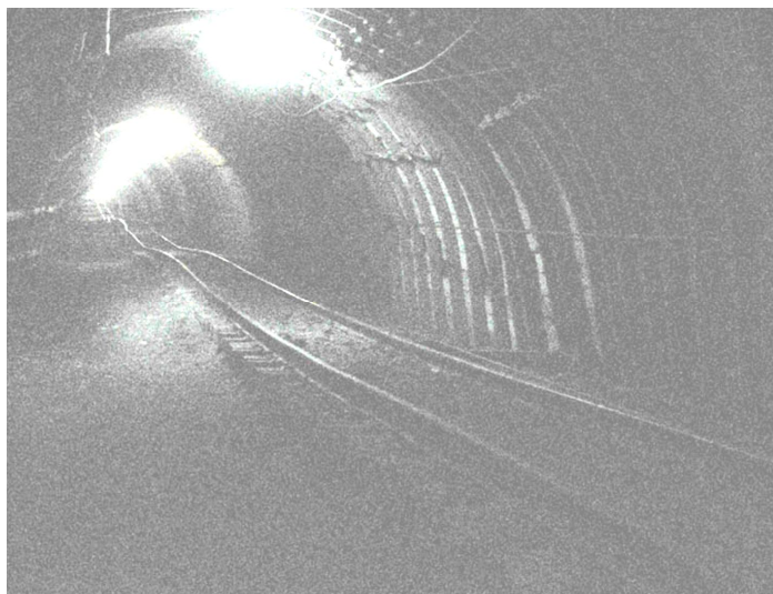
Рис. 1. Знакозмінний профіль рейкової колії – квершлаг пл. С 4 , шахта «Павлоградська» ПАТ «ДТЕК Павлоградвугілля»
