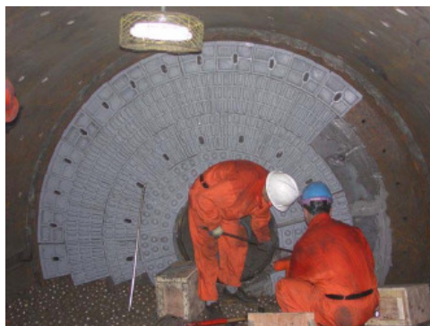
Рис. 4. Установка MML на загрузочном конце мельницы
