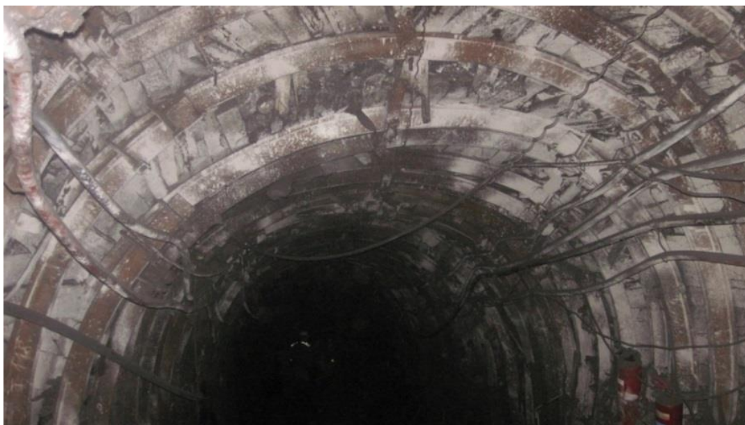
Рис. 2.20- «Заваливание» рам крепи в 3 северном конвейерном штреке пл. 1/ ОП «Шахта «Котляревская ГП «Селидовуголь»
