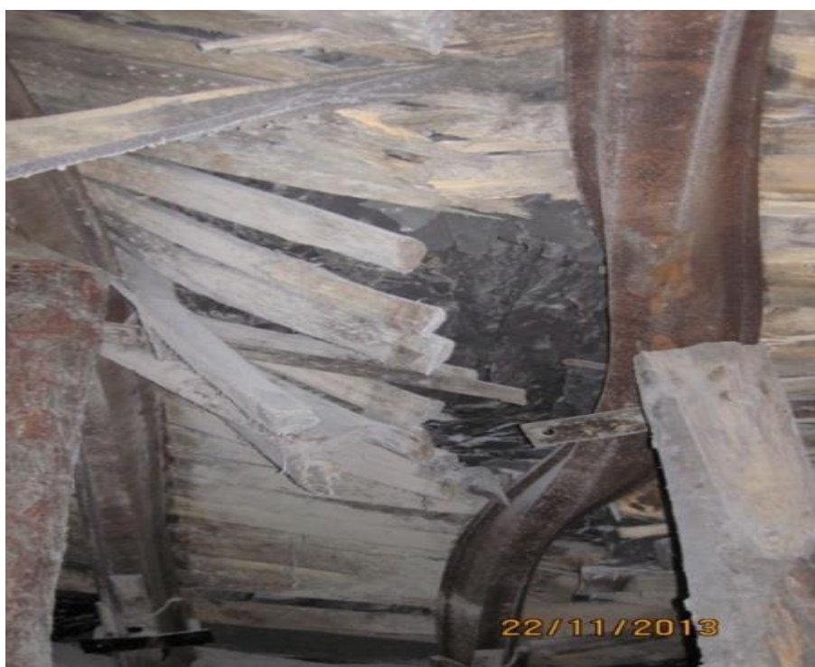
Рис. 2.21- Кручение стойки рамной стальной крепи 3-го северного конвейерного штрека пл. 1/ ОП «Шахта «Котляревская»
