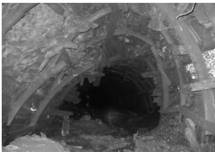
Рис. 5. Состояние 15-го западного откаточного штрека пласта h_{10} шахты «Партизанская» на участке с показателем устойчивости \omega = 0,325
