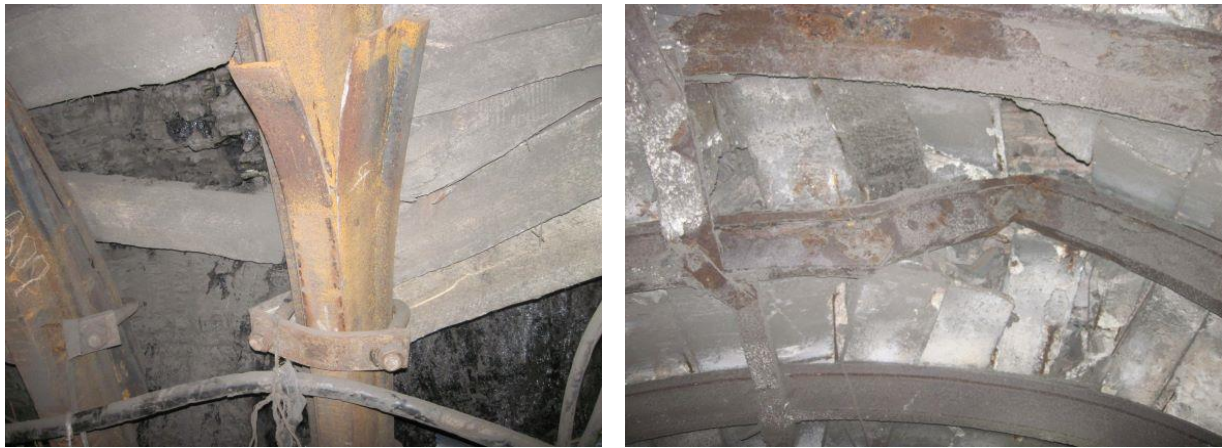
Рис. 4. Види руйнування кріплення на шахті «Білозерська»
