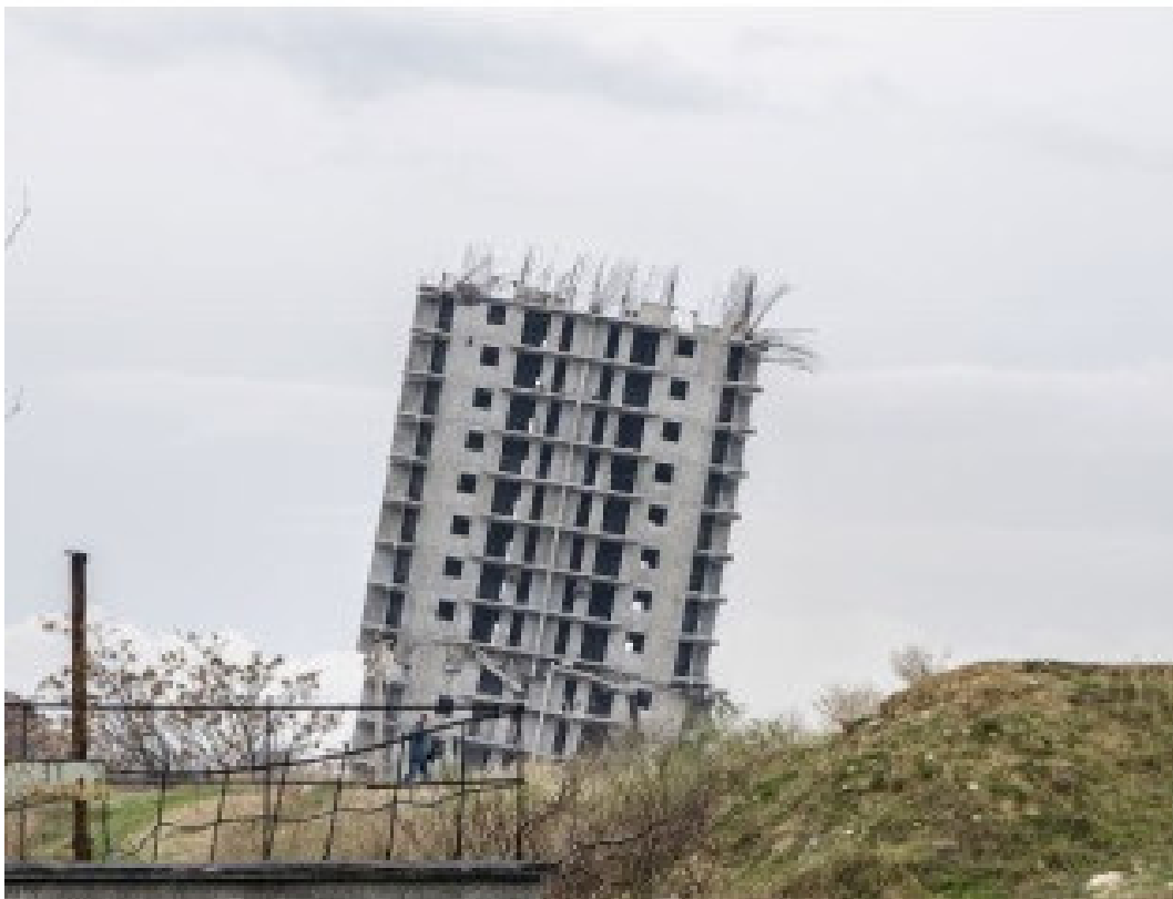
Рис. 1. Приклад наднормативного крену будівлі вже при початку будівництва
