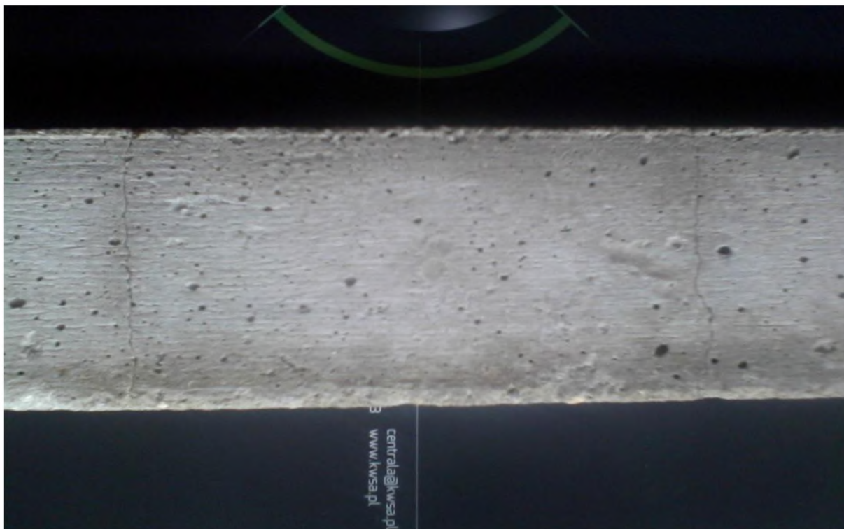
Рисунок 4.7 – Приклад наскрізної тріщини в зразку з композитного матеріалу після його нагріву до температури +40^{\circ}\text{C} і охолодження до температури +20^{\circ}\text{C}
