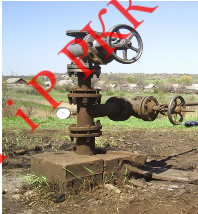
Рисунок 1.4 – Дегазаційна свердловина на полі шахти ім.О.Ф. Засядька [ http://www.igtm.dp.ua/index.php/uk/naukovi-rozrobky/34-uspishnyi-proekt-kompleksnoi-dehazatsii-ta-utyilizatsii-shakhtnoho-hazu-metanu ]
