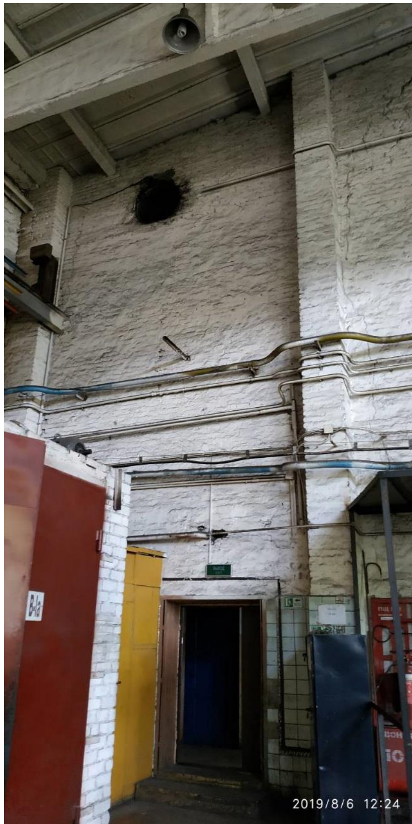
Фото І.46 – Магістральні силові тріщини в цегляній кладці на всю висоту стіни (між рядами А-В по осі 15). Вид з цеху
