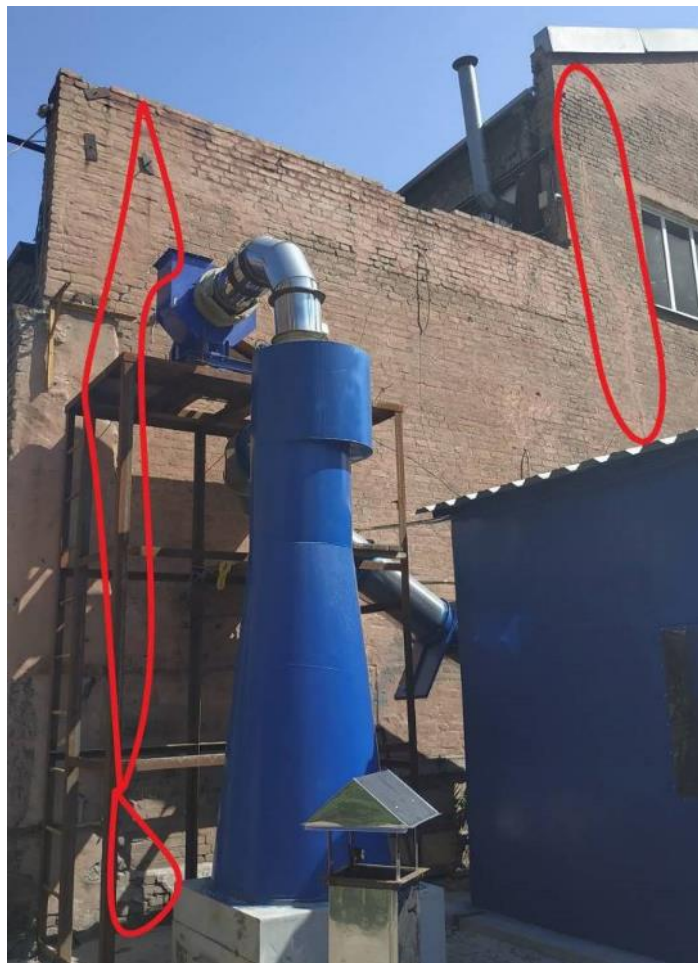
Фото І.21 – Магістральні силові тріщини в цегляній кладці на всю висоту стіни (Фасад Е-А)
