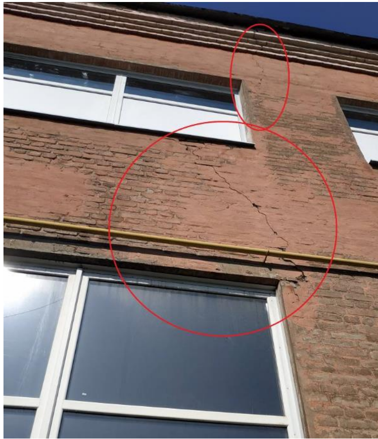
Фото І.14 – Тріщини в цегляній кладці (Фасад 1-17)
