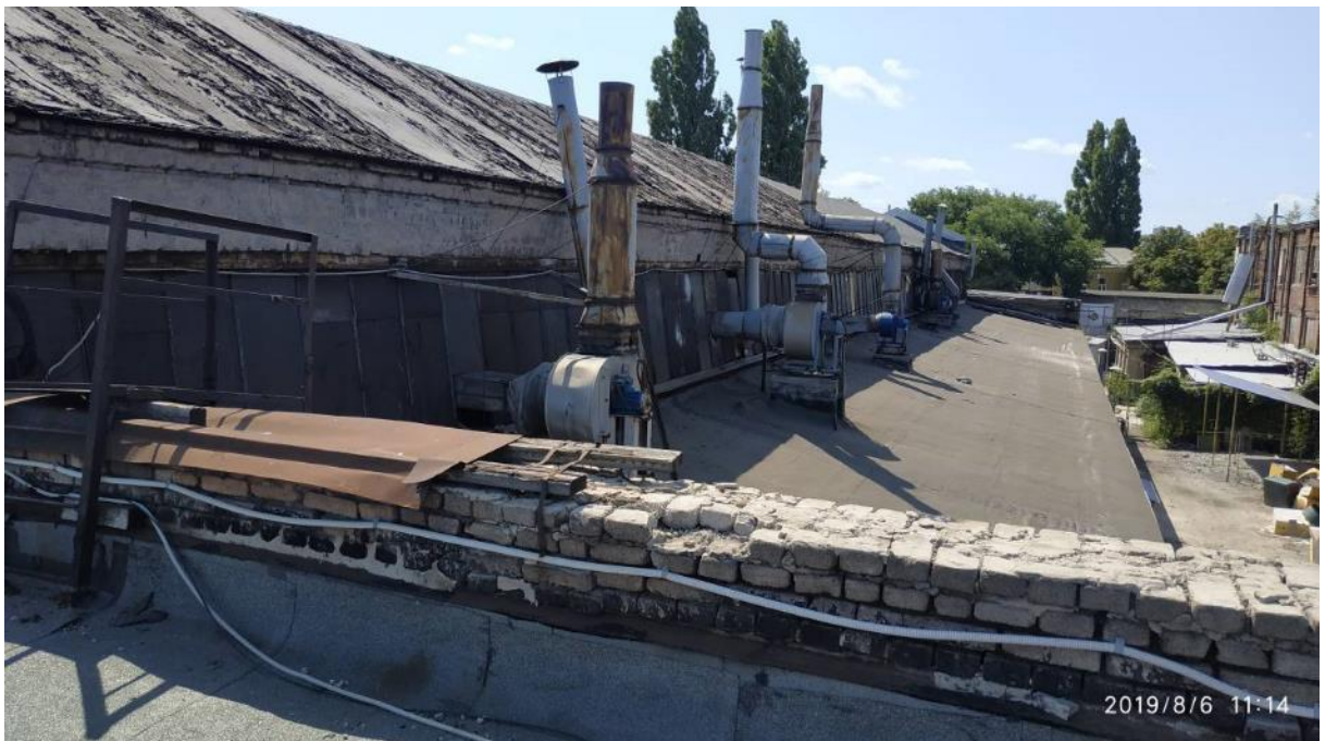
Фото І.38 – Порушення гідроізоляційного килима покриття, відрив / відсутність парапетного листа
