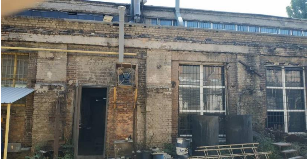
Фото I.27 – Виколювання і руйнування цегляної кладки, вивітрювання цем.- піщ. розчину (Фасад 17-1)
