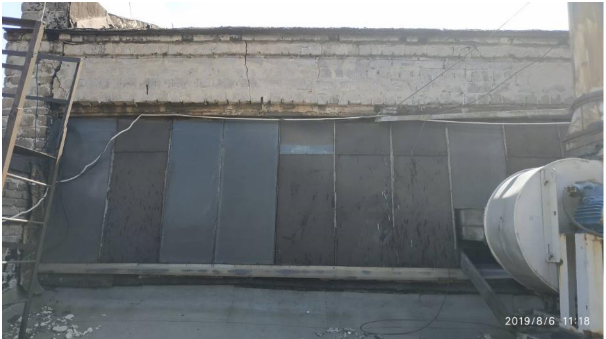
Фото I.33 – Тріщини в цегляній кладці
