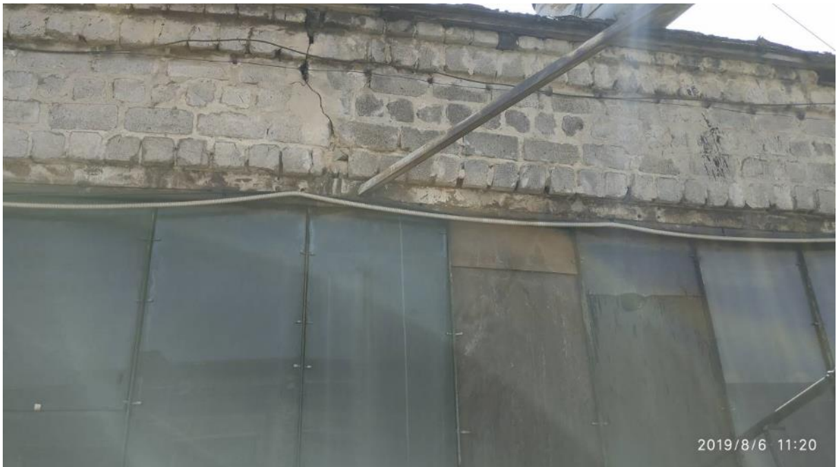
Фото I.34 – Тріщини в цегляній кладці
