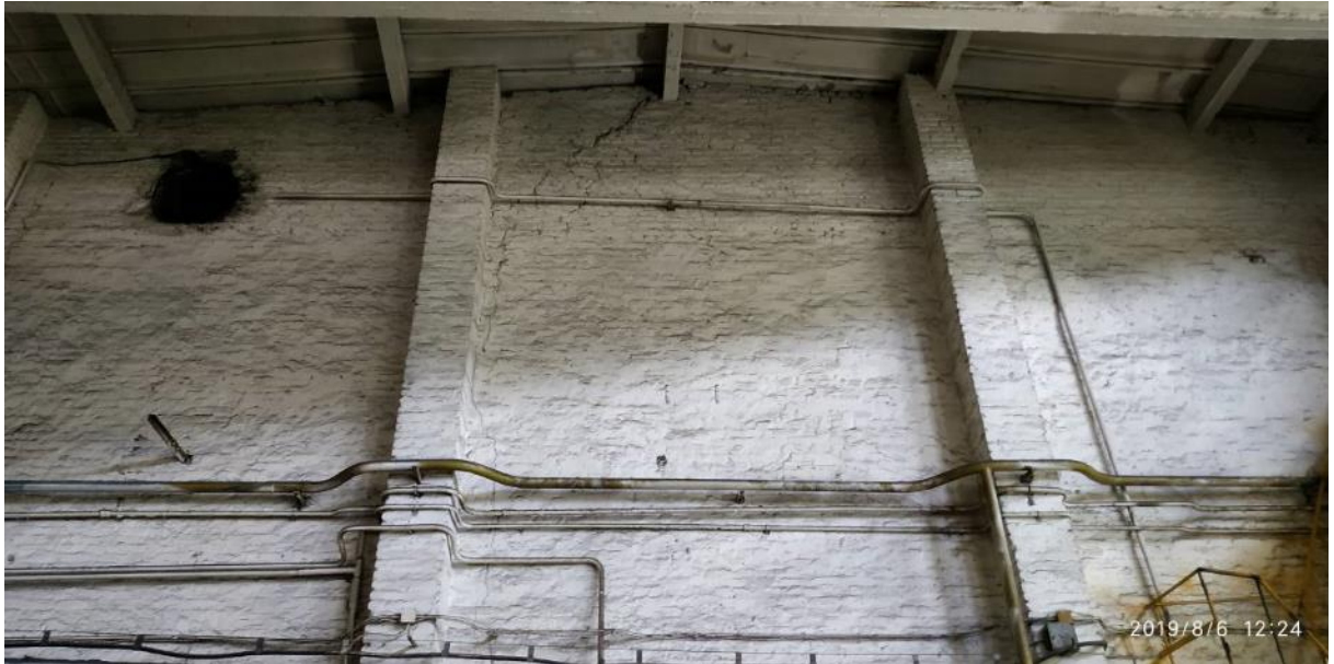
Фото І.47 – Магістральні силові тріщини в цегляній кладці на всю висоту стіни (між рядами А-В по осі 15). Вид з цеху
