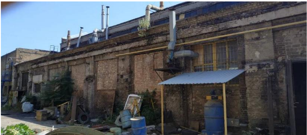
Фото I.28 – Виколювання і руйнування цегляної кладки, вивітрювання цем.- піщ. розчину (Фасад 17-1)
