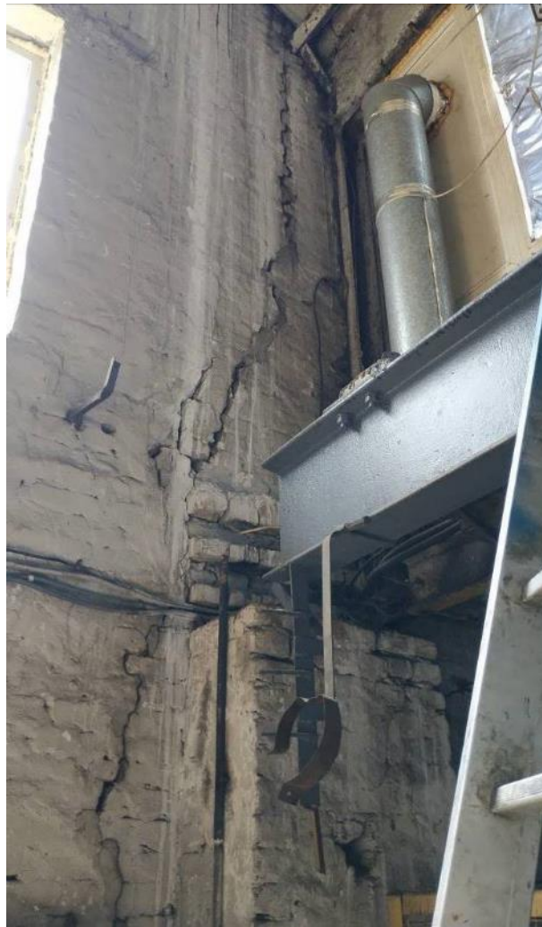
Фото I.42 – Магістральні силові тріщини
