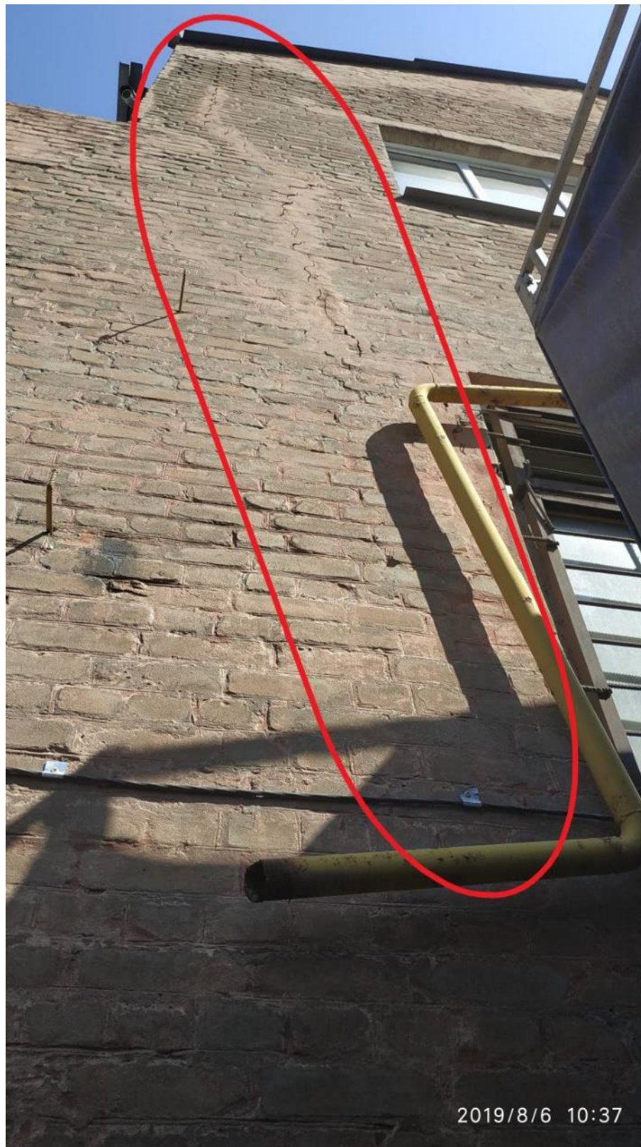
Фото І.22 – Магістральні силові тріщини в цегляній кладці на всю висоту стіни (Фасад Е-А)
