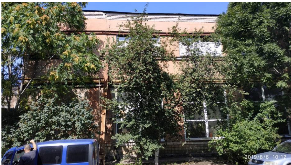
Фото І.4 – Частина фасаду 1-17 зі стяжкою и контрфорсом
