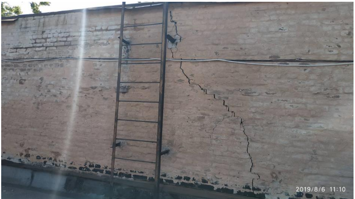
Фото І.48 – Магістральні силові тріщини в цегляній кладці на всю висоту стіни (між рядами А-В по осі 15). Вид з даху АПК
