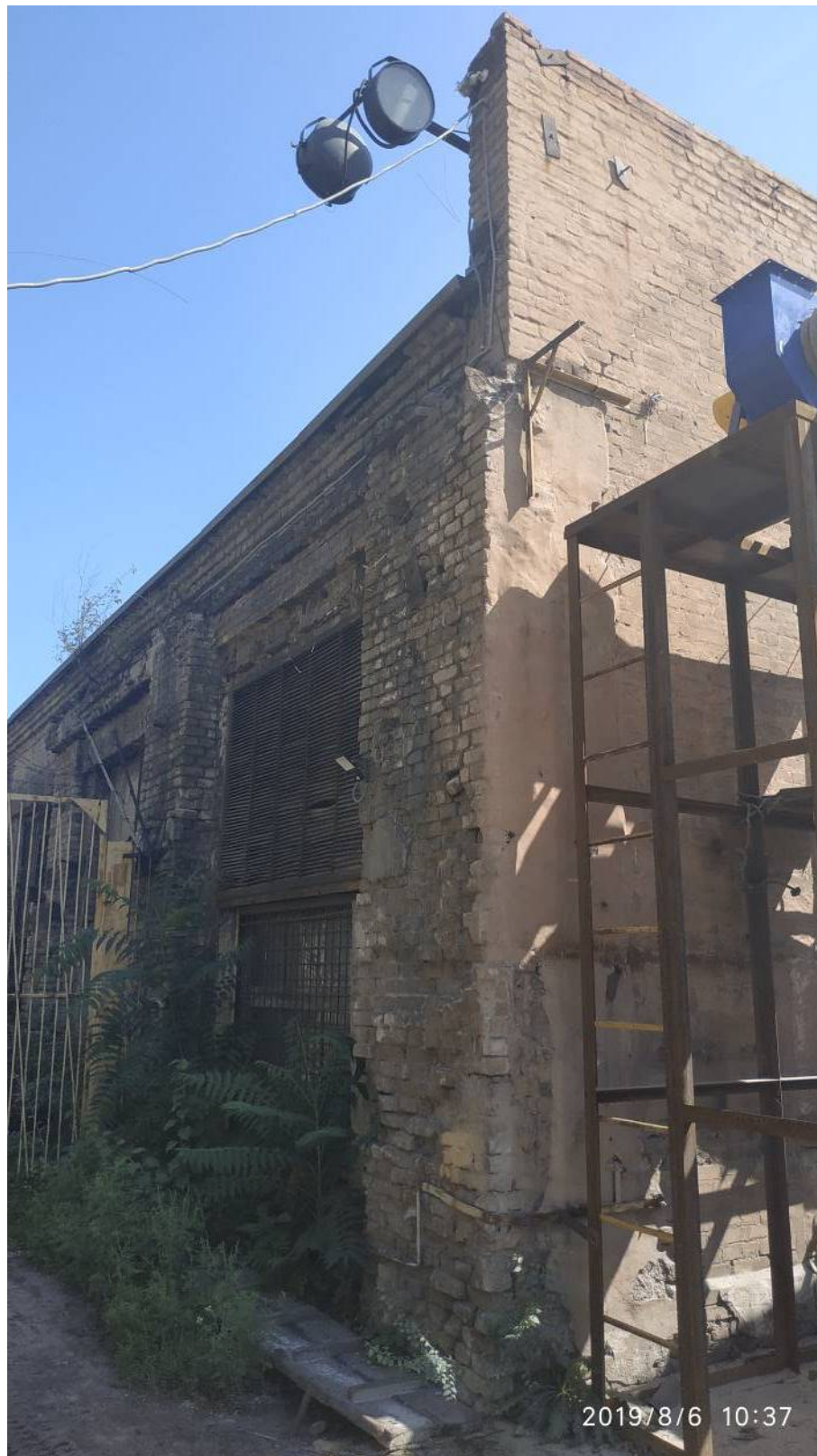
Фото І.23 – Виколювання і руйнування цегляної кладки, вивітрювання цем.- піщ. розчину (Фасад 17-1)
