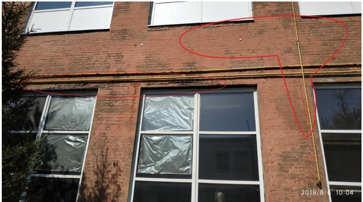
Фото І.15 – Тріщини в цегляній кладці, вивітрювання цем.-піщ. розчину, відшарування захисного шару бетону (Фасад 1-17)
