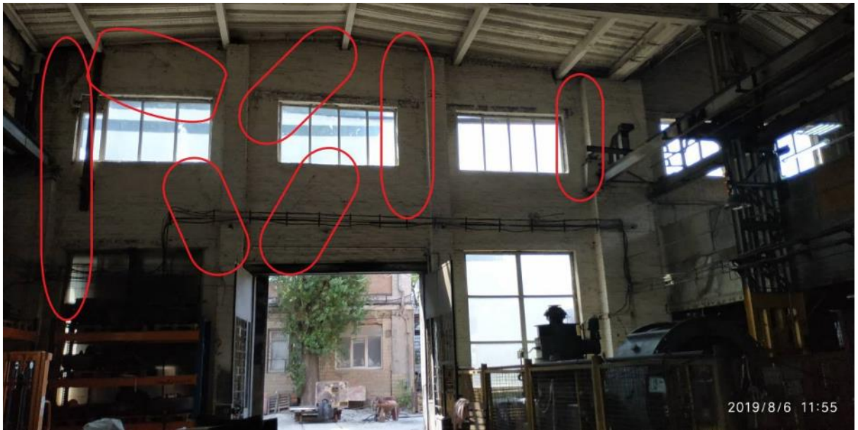
Фото І.40 – Тріщини в цегляній кладці (Стіна зсередини по осі 1)
