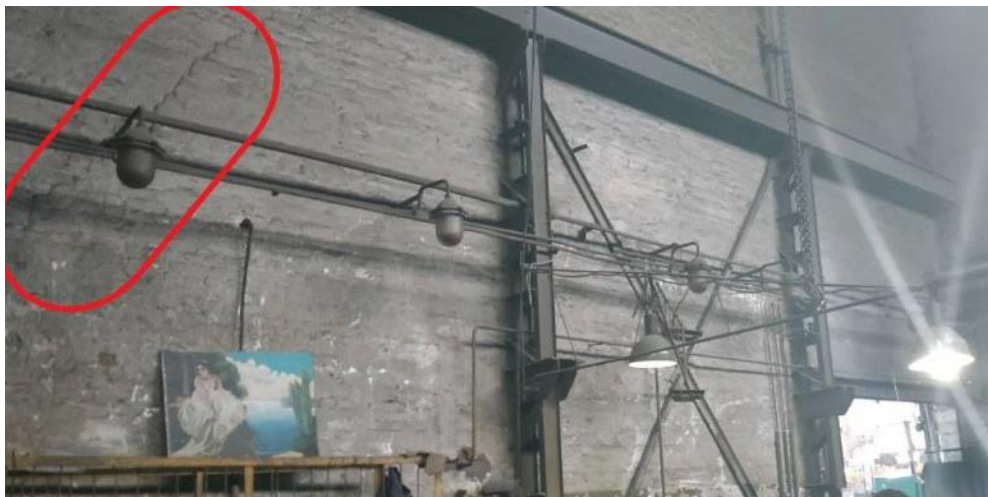
Фото I.45 – Тріщини в цегляній кладці (Ряд В, вісь 8-10)
