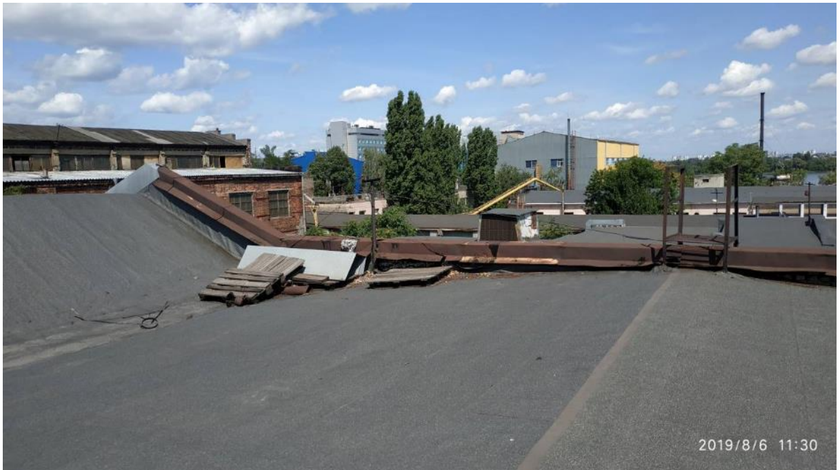
Фото І.37 – Наявність будівельного сміття на покрівлі будинку
