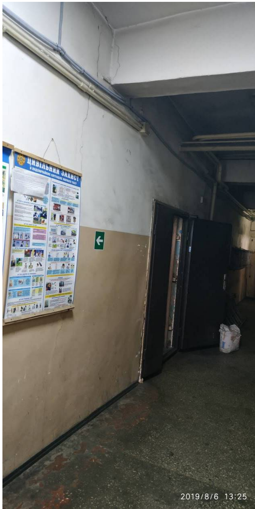
Фото І.50 – Тріщини в цегляній кладці
