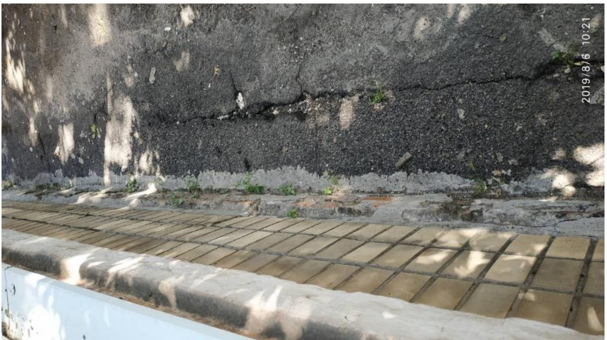
Фото І.19 – Руйнування асфальтобетонного вимощення (мережа тріщин) - Фасад 1-17
