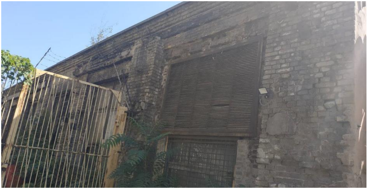
Фото I.24 – Виколювання і руйнування цегляної кладки, вивітрювання цем.- піщ. розчину (Фасад 17-1)
