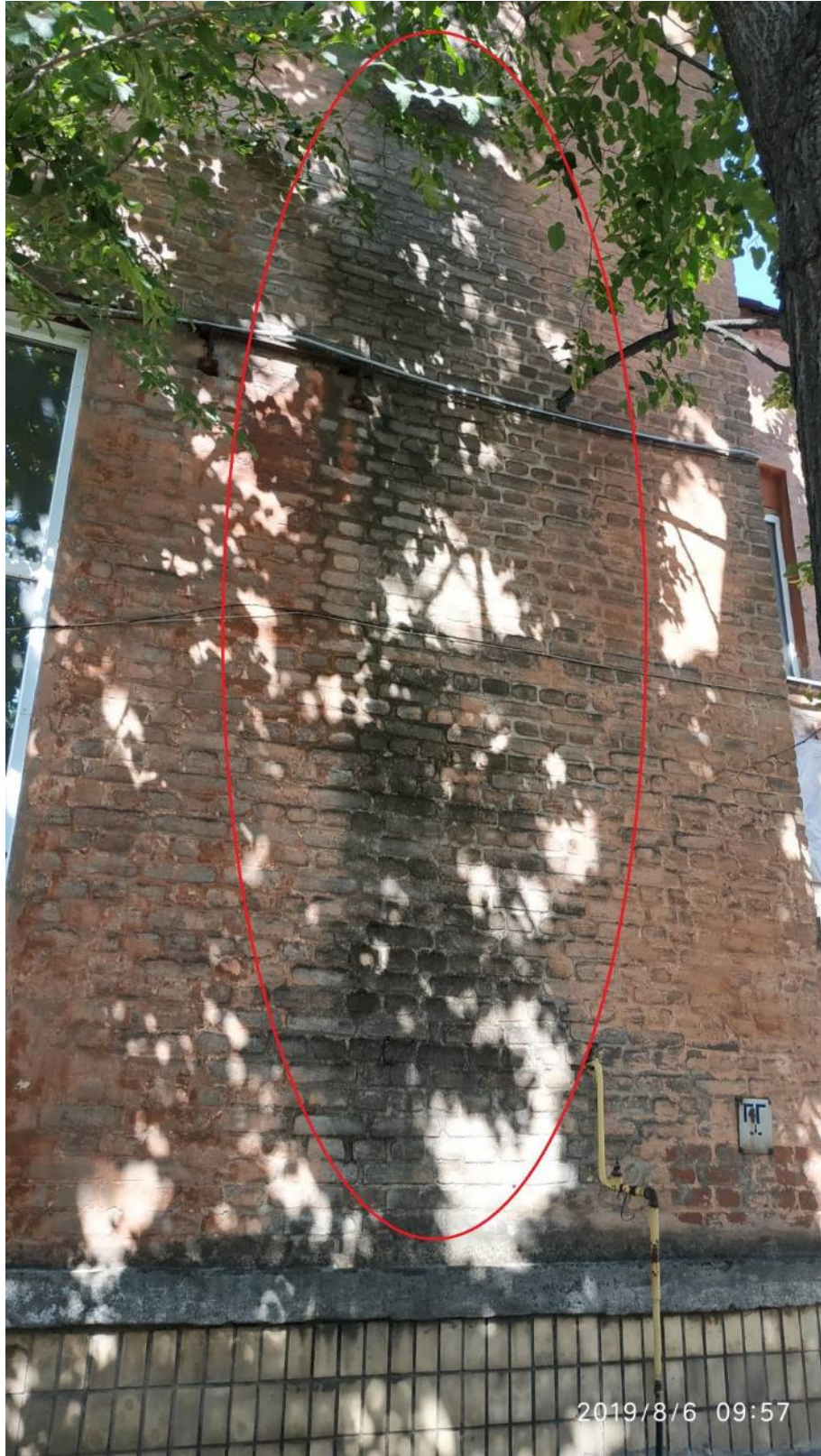
Фото І.13 – Сліди замочування цегляної кладки (Фасад 1-17)
