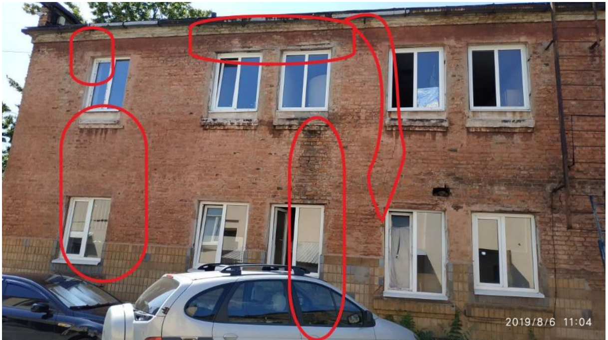
Фото І.31 – Тріщини в цегляній кладці
