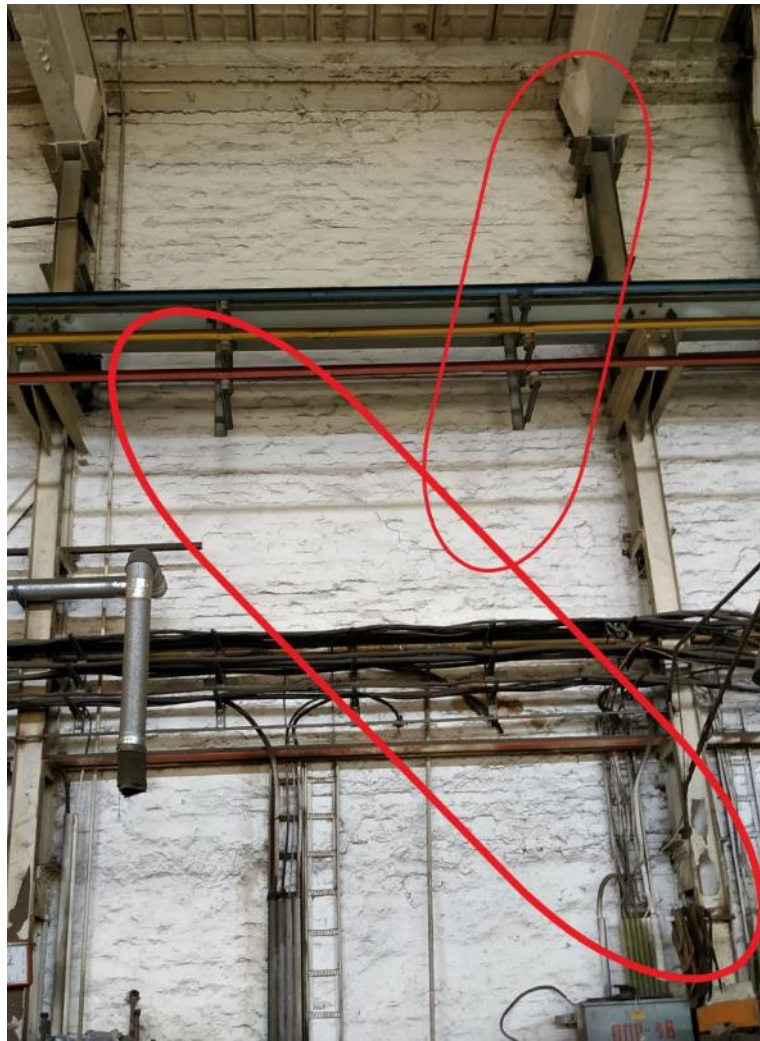
Фото I.44 – Тріщини в цегляній кладці (Ряд В, вісь 8-10)
