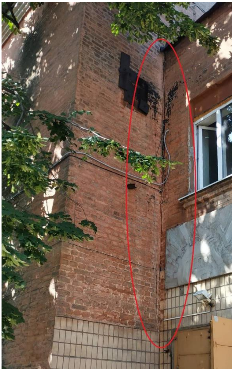
Фото І.12 – Магістральні силові тріщини в цегляній кладці на всю висоту стіни (примикання АПК до цеху. Фасад 1-17)
