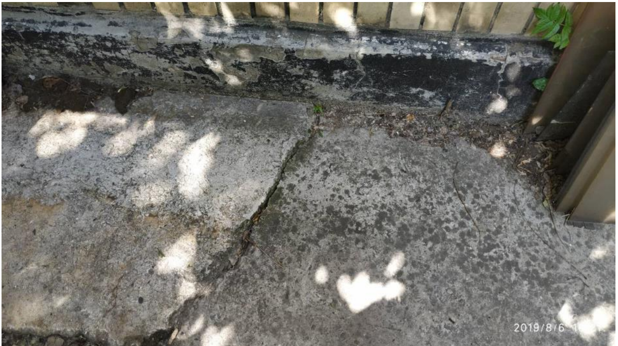
Фото І.18 – Руйнування асфальтобетонного вимощення (мережа тріщин) - Фасад 1-17
