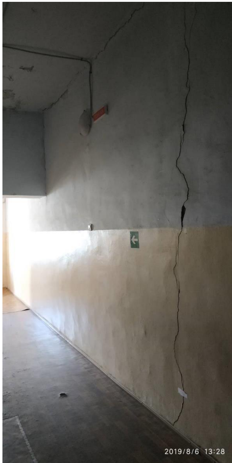
Фото І.49 – Магістральні силові тріщини в цегляній кладці на всю висоту стіни (між рядами А-В по осі 15). Вид з АПК
