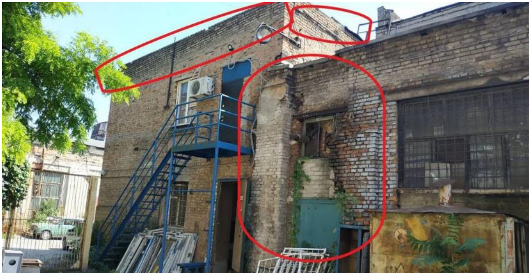
Фото І.29 – Відсутність парапетного листа, тріщини в цегляній кладці, вивітрювання цем.-піщ. розчину, виколювання цегляної кладки
