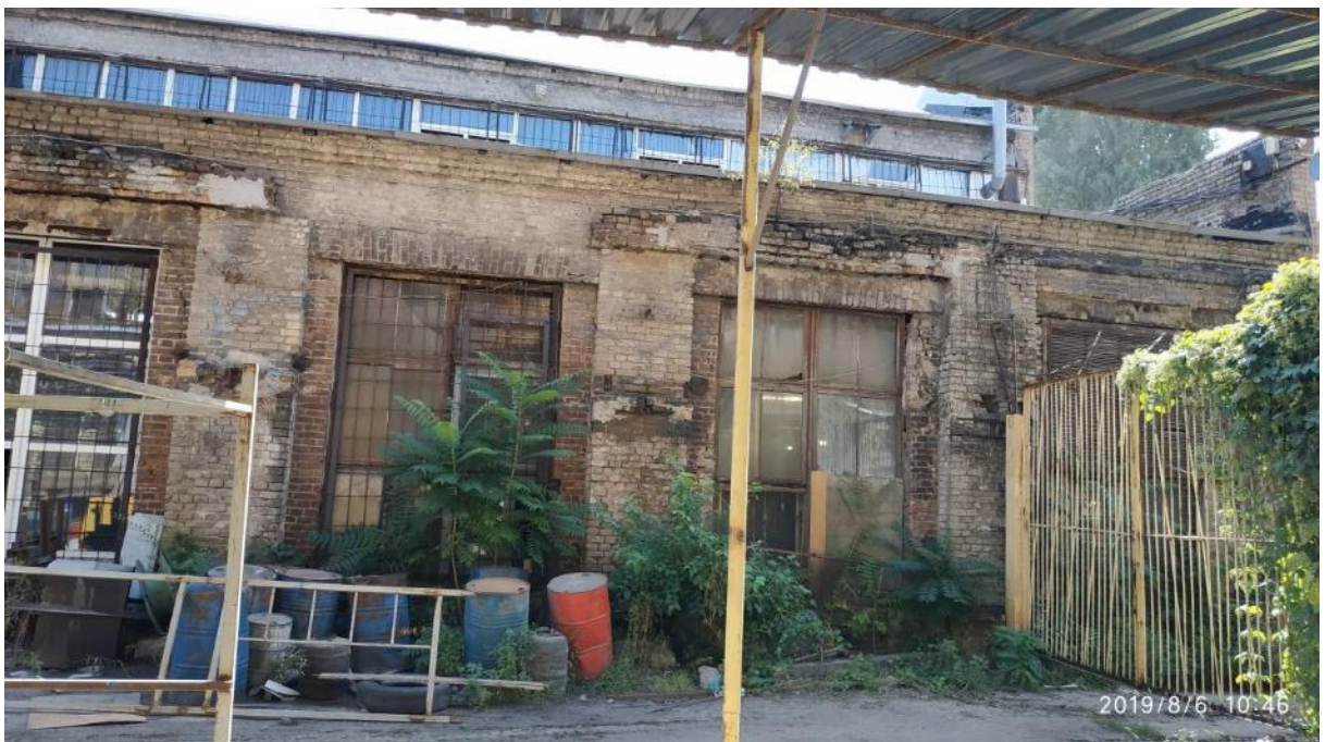
Фото I.25 – Виколювання і руйнування цегляної кладки, вивітрювання цем.- піщ. розчину (Фасад 17-1)
