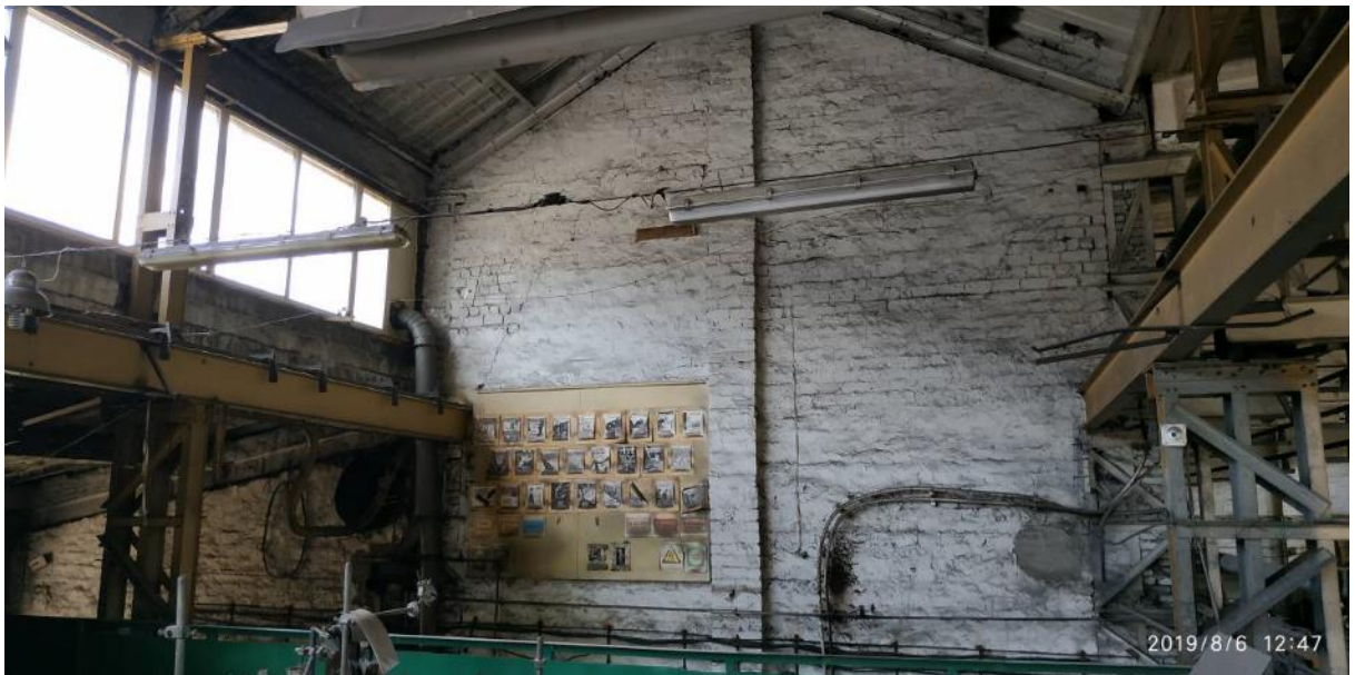
Фото I.43 – Тріщини в цегляній кладці
