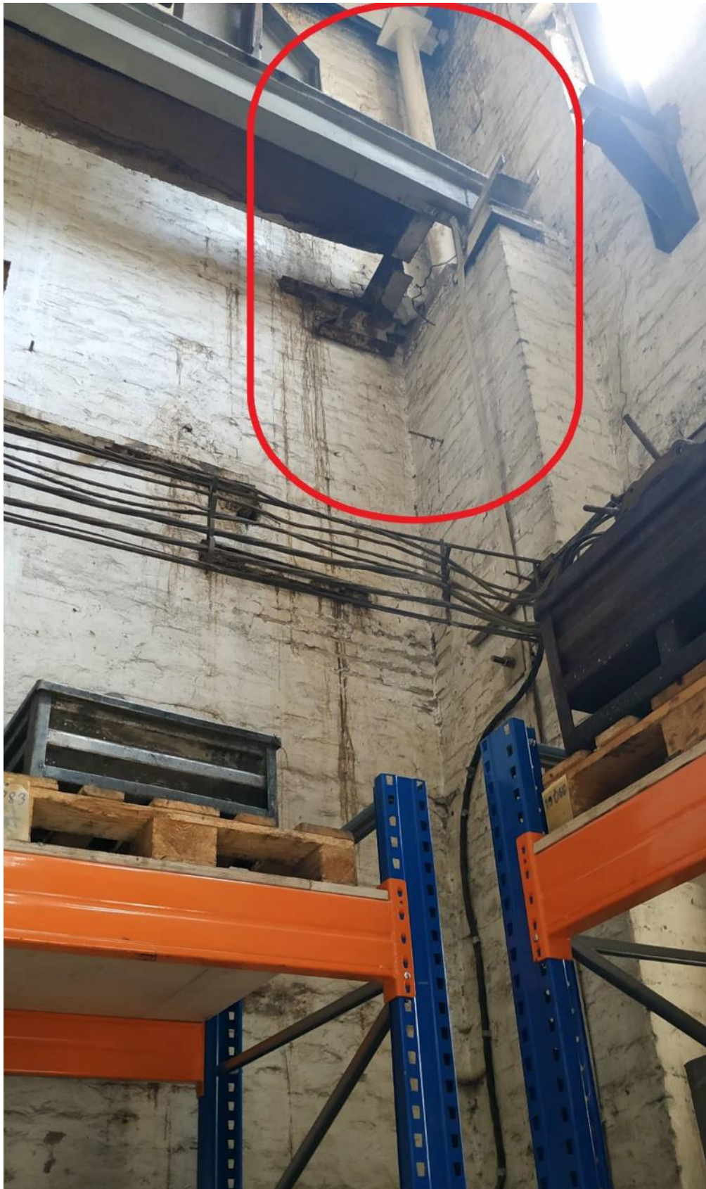
Фото І.39 – Вихід з проектної площини фрагментів цегляної кладки, магістральні тріщини в цегляній кладці
